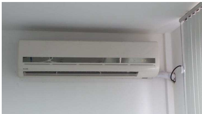
FIGURA 17: AR CONDICIONADO INSTALADO NA SALA
