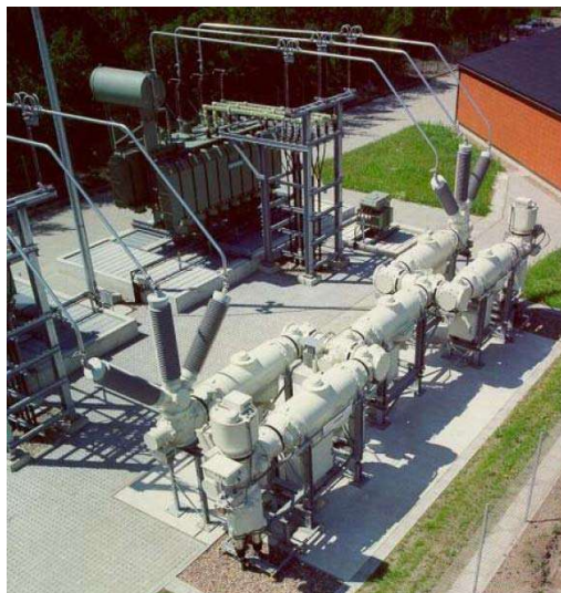
Figura 22: Disjuntor Isolado a gás.
