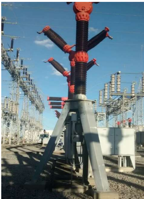
Figura 6: Disjuntor PVO de 230 kV.
