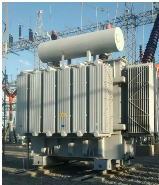
Figura 7: Transformador de potência de 230/69 kV.
