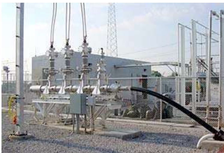
Figura 21: Cabo supercondutor - subestação bixby, USA.
