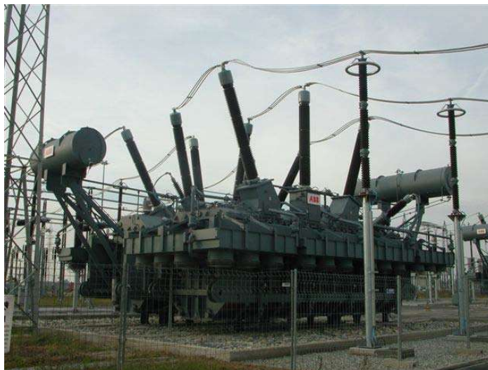
Figura 14: Subestação Rondissone de 400 kV, em Terna, na Itália
