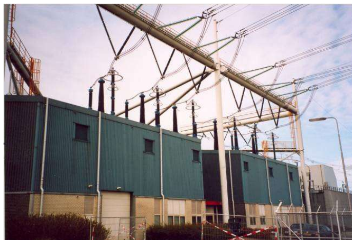
Figura 16: Subestação Meeden de 400 kV, abrigada, em Tennet, na Alemanha.
