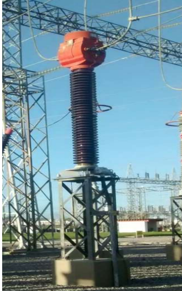
Figura 5: Transformador de corrente de 230 kV.
