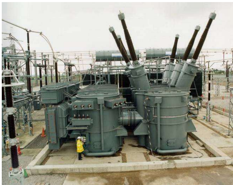
Figura 18: Transformador isolado a gás externo de 400 kV e 2750 MVA.
