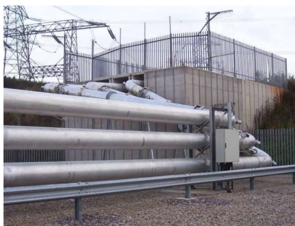
Figura 20: Linha isolada a gás.
