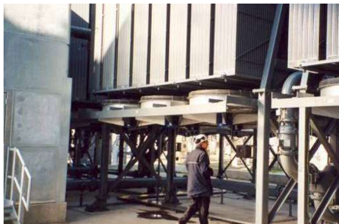
Figura 19: Coolers externos para TIG de 400 kV e 2750 MVA.
