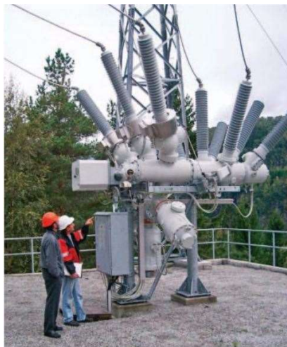
Figura 27: PASS de 100 kV com barramento duplo, em Norway.
