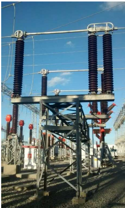
Figura 3: Chave seccionadora de 230 kV.
