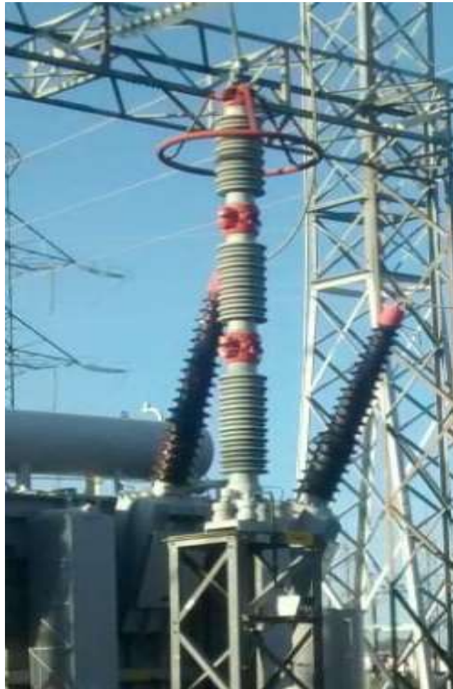
Figura 2: Para-raios de porcelana de 230 kV.
