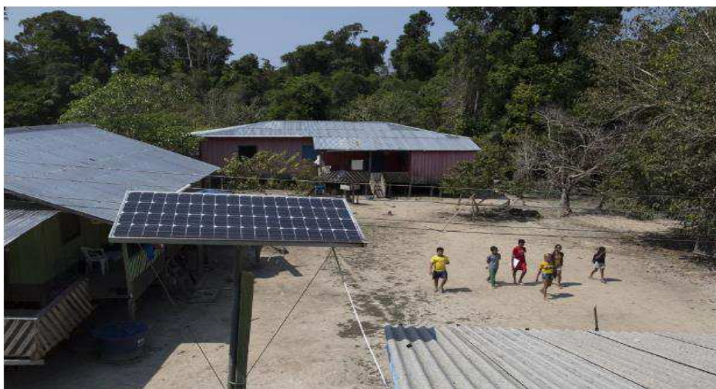
Figura 7: Sistema off-grid instalado em uma escola.
