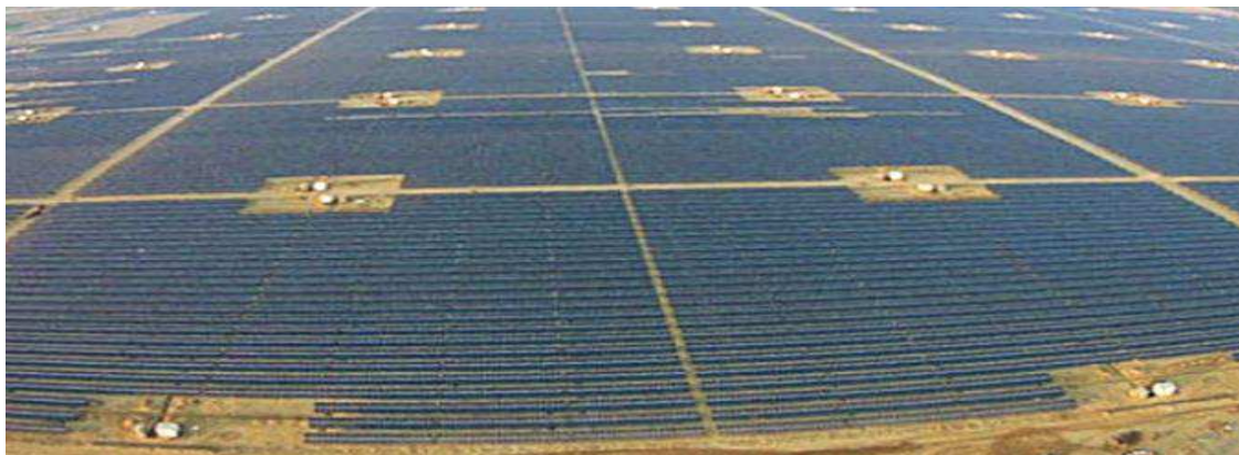
Figura 16: Usina solar fotovoltaica de kamuthi solar power project .
