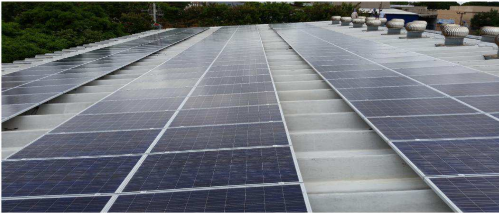
Figura 11: Fotografia minigeração fotovoltaica em uma indústria.
