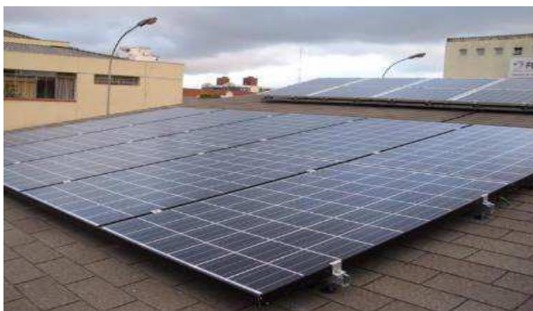
Figura 9: Fotografia da implantação de um sistema de distribuição em microgeração fotovoltaica em uma Empresa.
