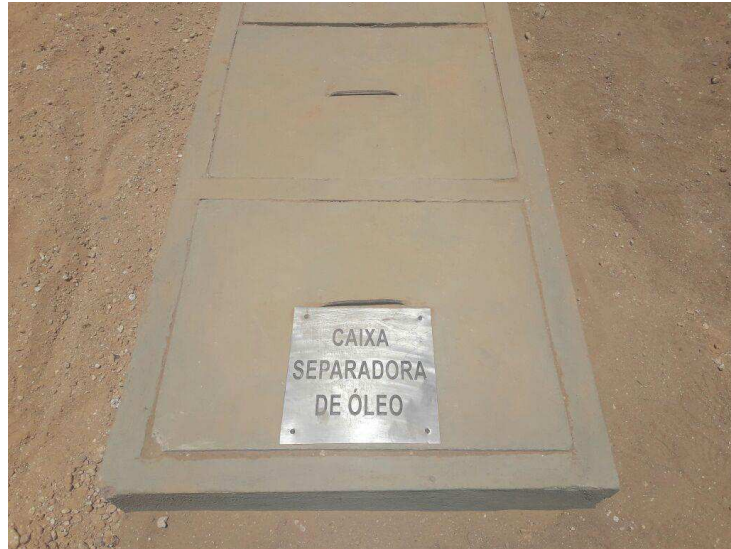
Figura 12 – Fotografia da caixa separadora de óleo
