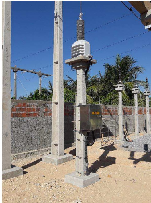
Figura 18 – Fotografia de um Transformador de Potencial
