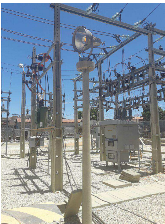
Figura 33 – Fotografia do poste de iluminação
