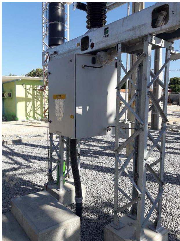
Figura 26 – Fotografia de um Disjuntor a gás SF6
