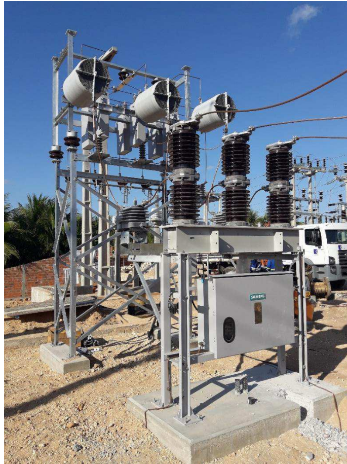
Figura 30 – Fotografia do conjunto de equipamentos que formam o Banco de Capacitor.
