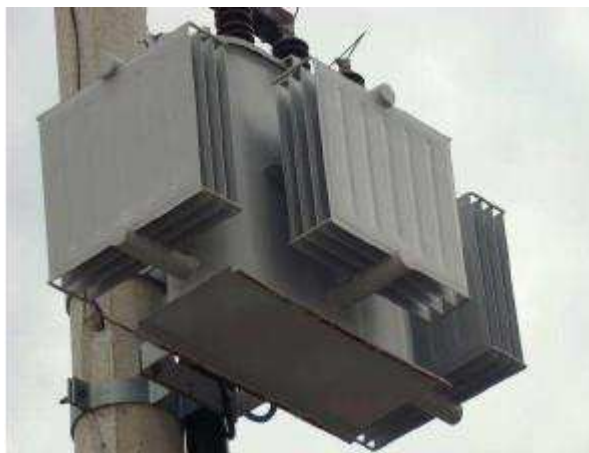
Figura 31 – Fotografia do Transformador de distribuição
