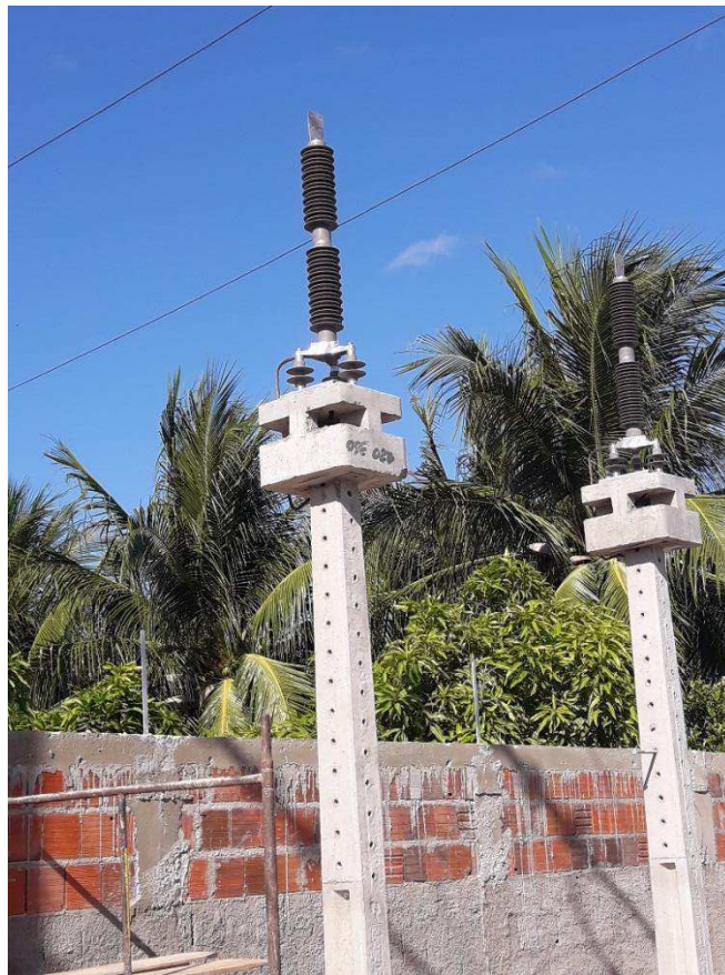
Figura 29 – Fotografia de um dos Para-raios 69KV instalado na SE
