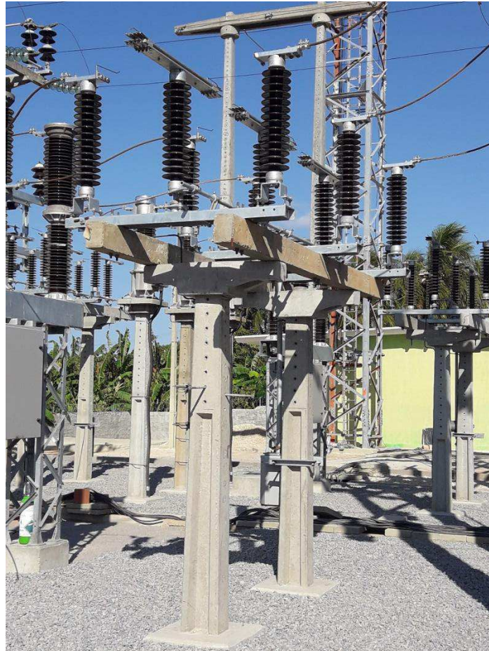
Figura 24 – Fotografia de uma das chaves instalada na SE
