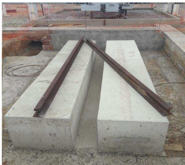
Figura 9 – Fotografia da base de um dos transformadores.
