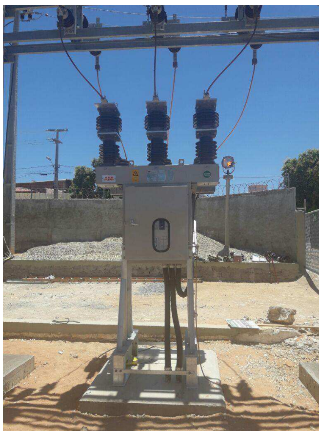
Figura 25 – Fotografia de Disjuntor a vácuo 13,8 KV
