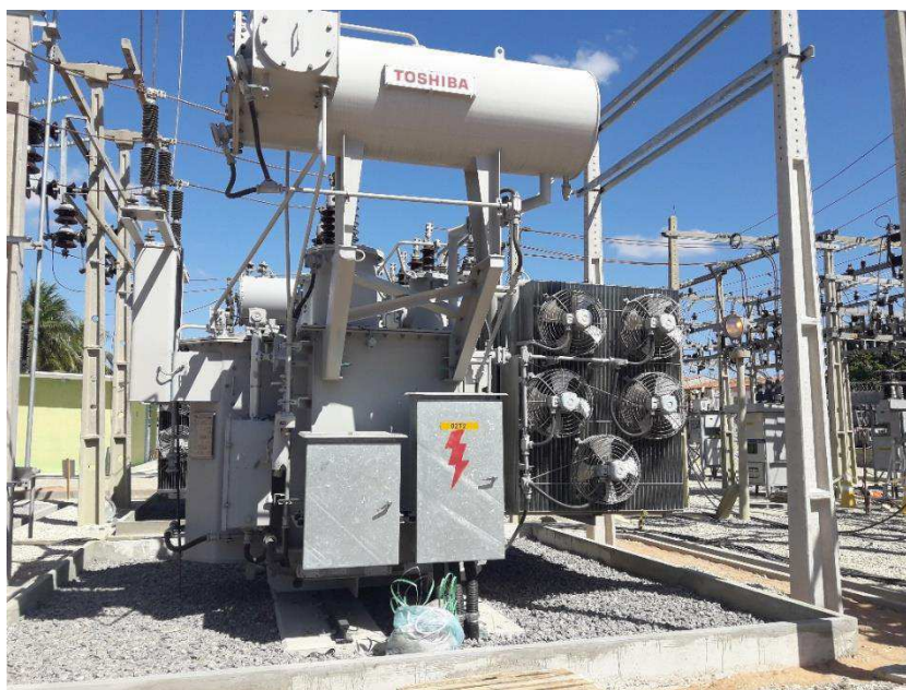
Figura 32 – Fotografia do Transformador de força de 12,5 MVA
