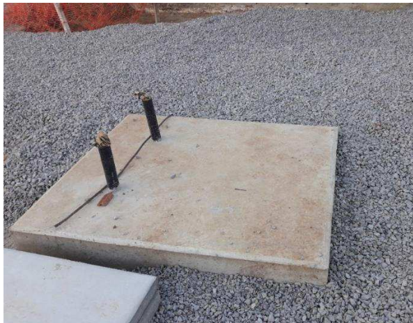
Figura 8 – Fotografia de uma das bases dos disjuntores instalados.
