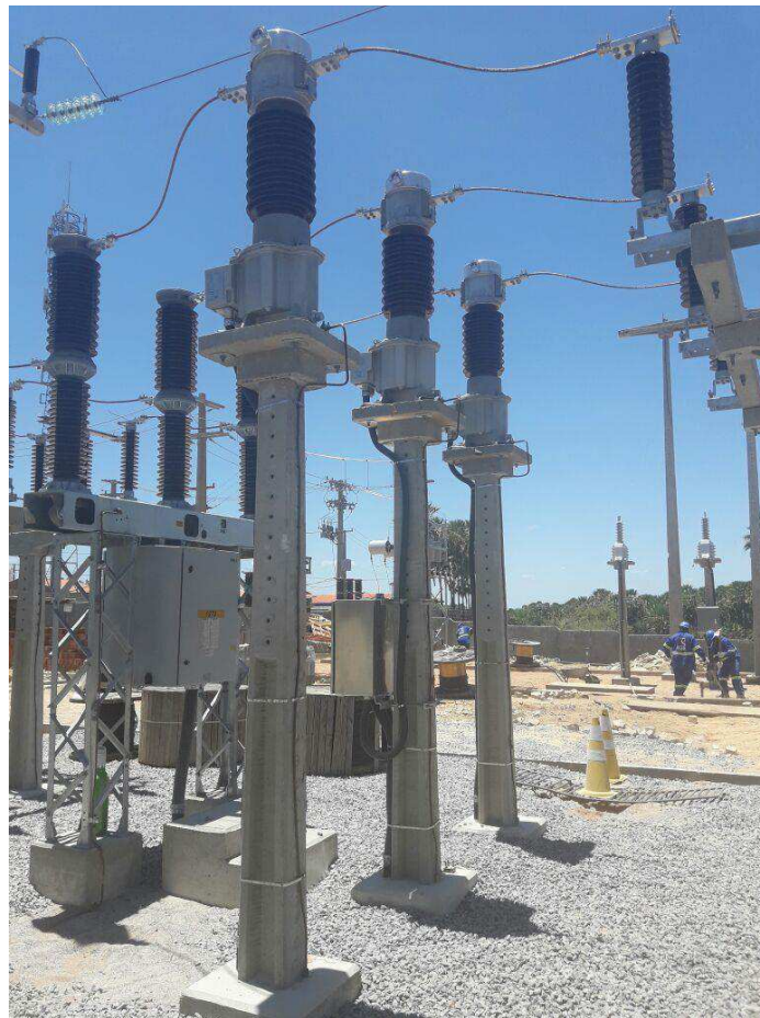
Figura 16 – Fotografia de um transformador de corrente
