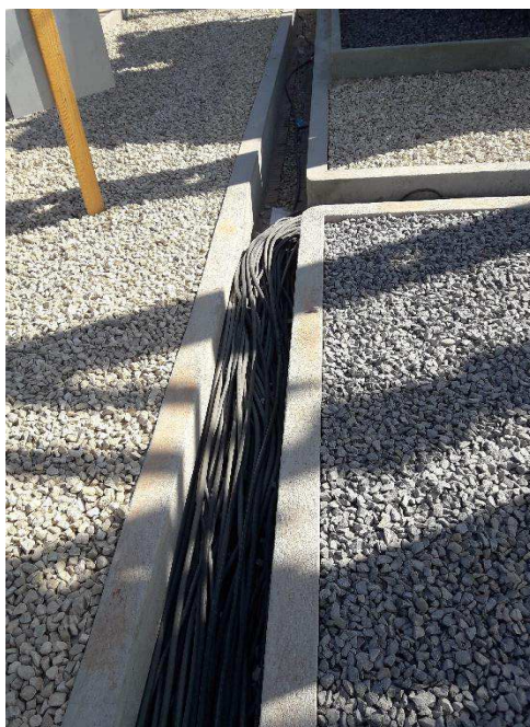
Figura 11 – Fotografia de uma canaleta aberta
