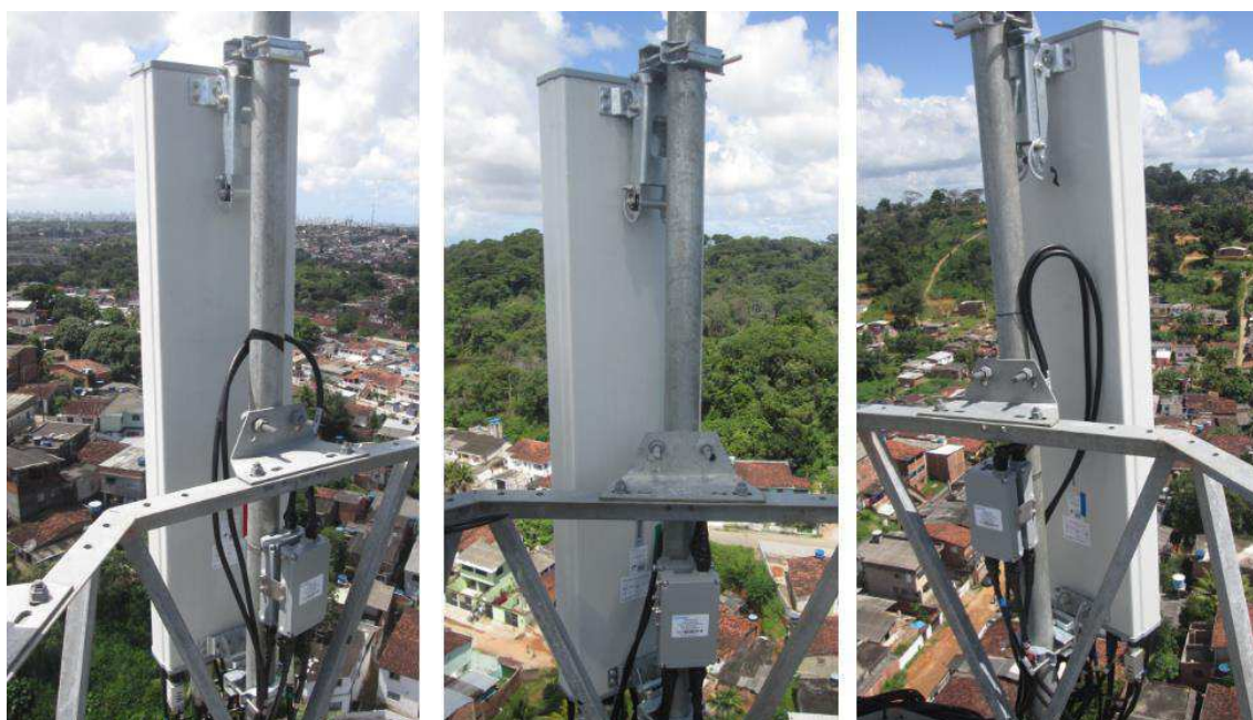
Figura 13: Antenas Quadband instaladas no site SLJGCR07
