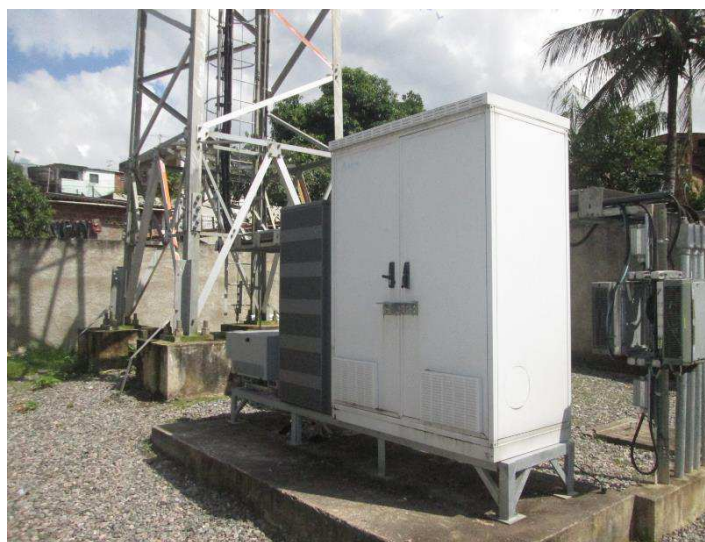
Figura 9: Vista Geral dos Equipamentos da Tim existentes no site
