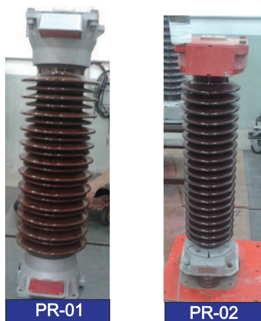
Figura 35 – Fotografia dos para-raios PR-01 e PR-02.
