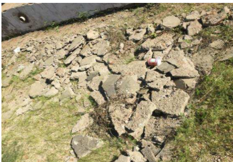
Figura 5: Resíduo encontrado na obra.
