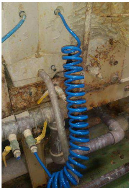
Figura 12. Modificação proposta para a redução de pontos de vazamento de ar nas bancas de fundição de bacias.
