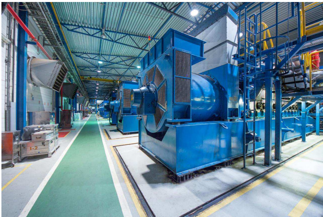
Figura 8 - Sala de Máquinas de uma Usina Termoelétrica.
