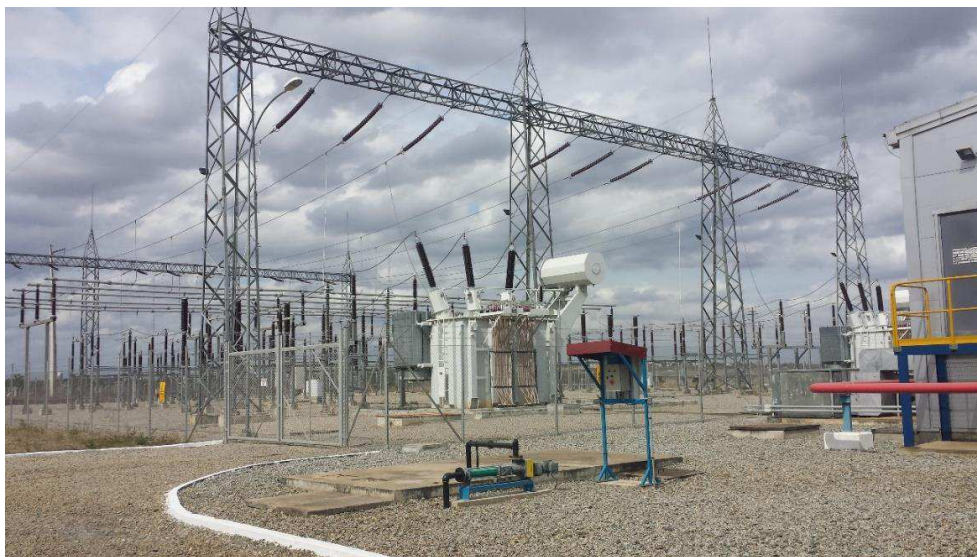
Figura 9 - Subestação 230 kV na usina.
