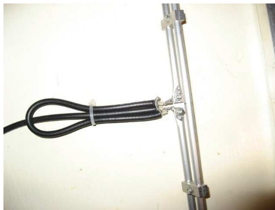
Figura 6.12: Detalhe de um balun.
