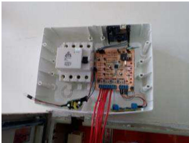
Figura 11 - Medidor de energia elétrica confeccionado pelo projeto SCIKE Paraíba.
