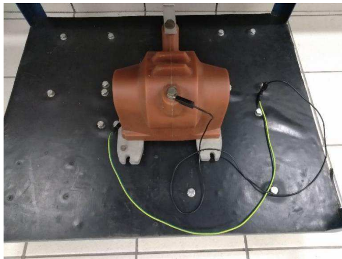
FIGURA 15: TP INDUTIVO DE PROTEÇÃO 13.800/115 V
