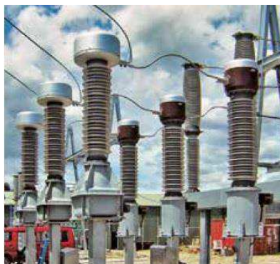
FIGURA 1: TRANSFORMADORES DE POTENCIAL INDUTIVO DE 123 KV.
