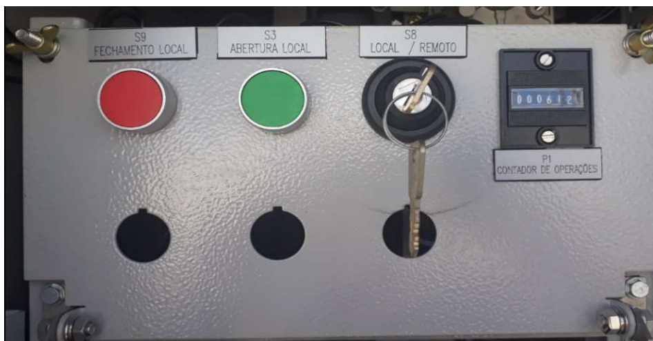
Figura 21: Botoeiras para comando local e chave Local/Remota do disjuntor 69kV
