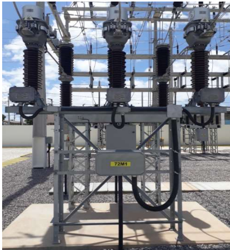
Figura 2: Fotografia de um Transformador de corrente
