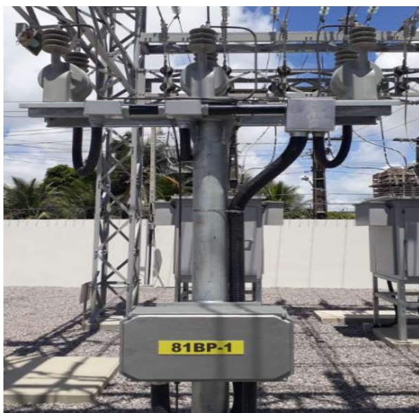
Figura 5: Fotografia de um Transformador de Potencial
