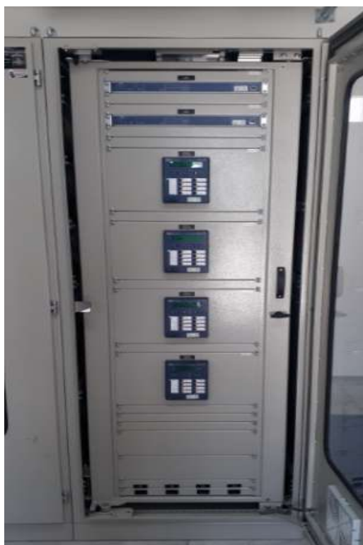
Figura 12: Relés instalados em um painel de controle
