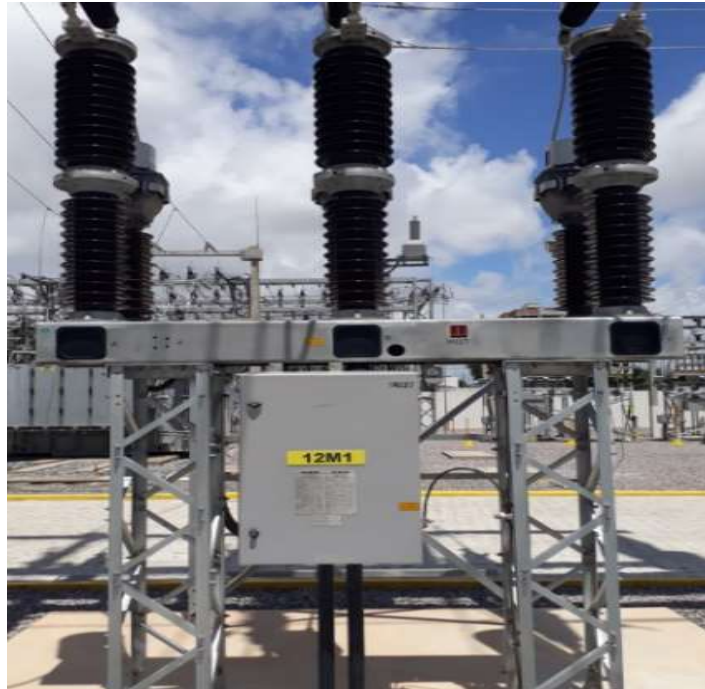
Figura 7: Disjuntor a Gás SF6 69kV
