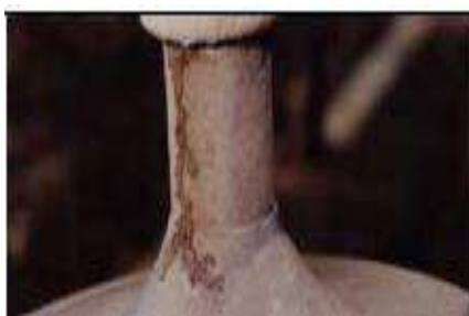
Figura 11 - Trilhamento Elétrico em Isolador Polimérico.
