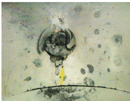
Figura 9 - Tiros em Aletas de Isoladores Poliméricos.
