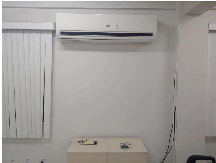
Figura 19: Posicionamento do bloco de infravermelho sob o condicionador de ar.
