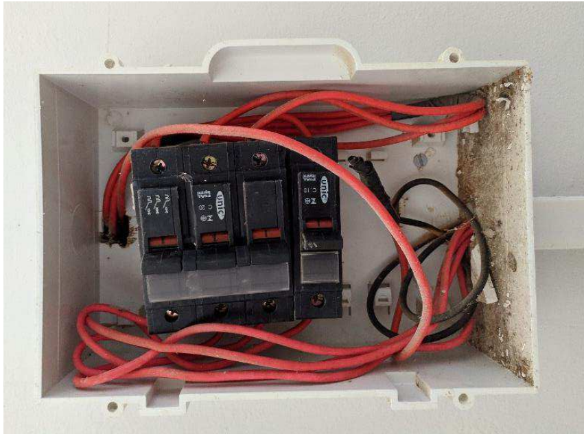
Figura 23: Quadro elétrico sem porta
