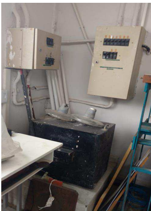
Figura 20: Quadro elétrico obstruído
