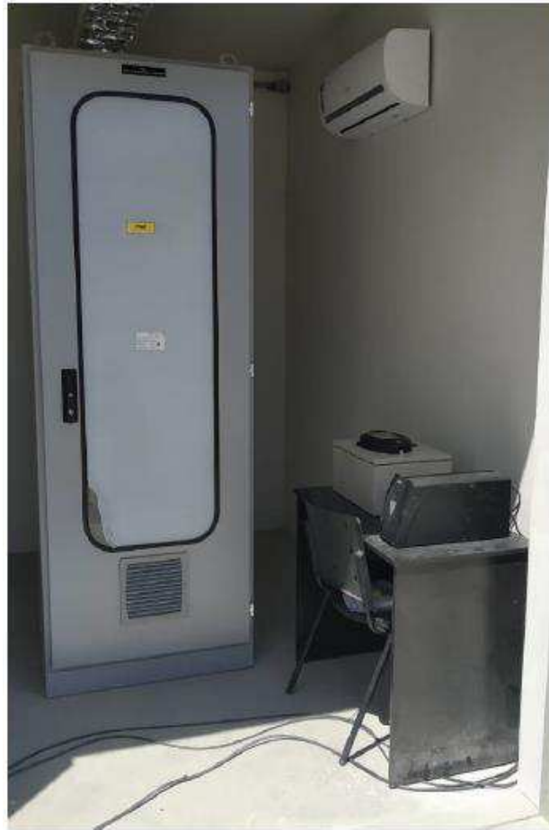
Figura 12 - Medidor instalado na casa de faturamento.
