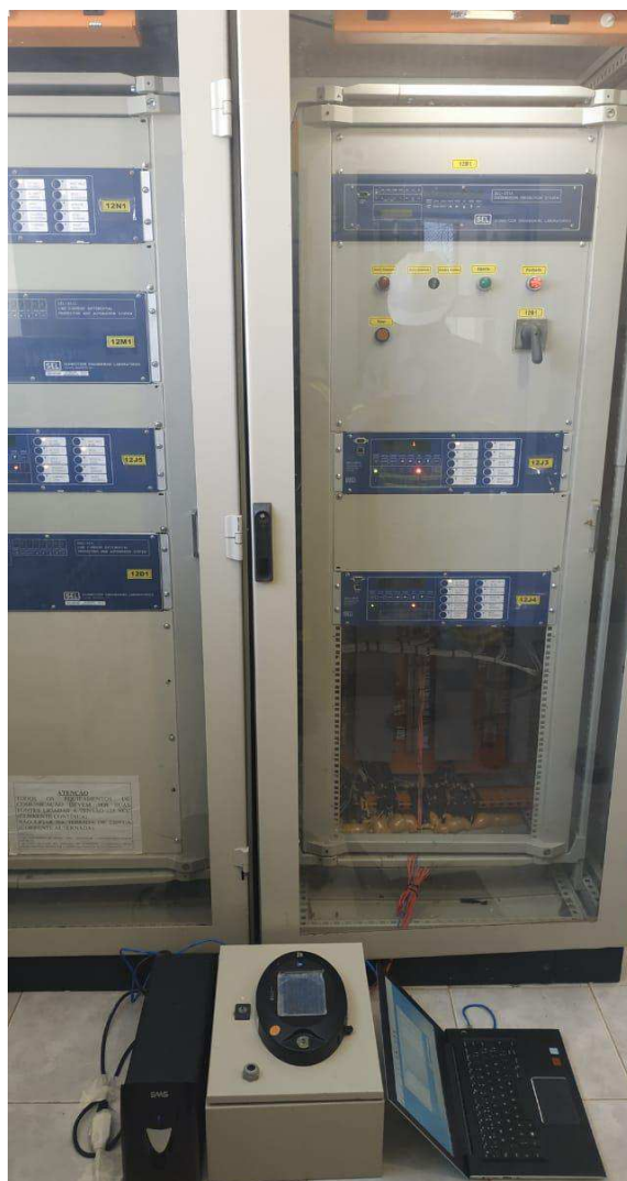
Figura 25 - Medidor instalado na casa de comando.
