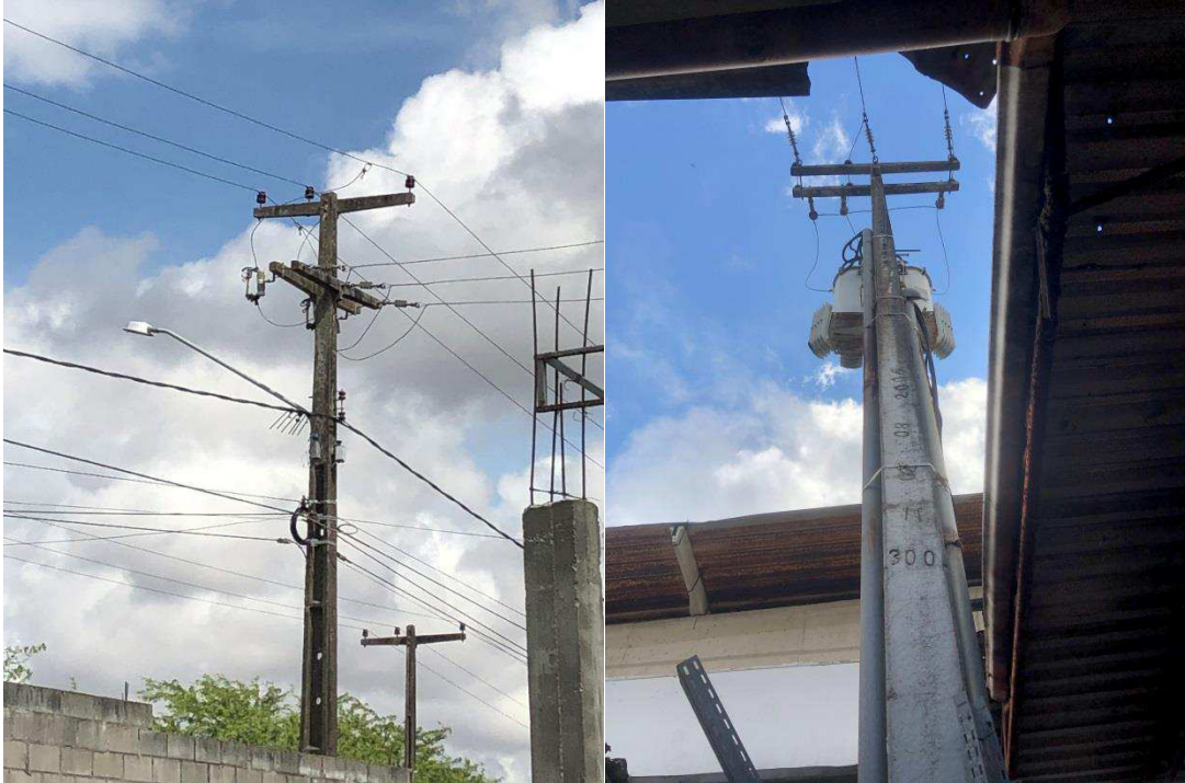
Figuras 13 A e B – Entrada de energia da fábrica de calçados.
