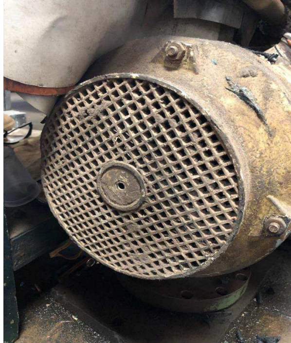
Figura 27: Motor da fábrica com ventilação ineficiente por excesso de sujeira.
