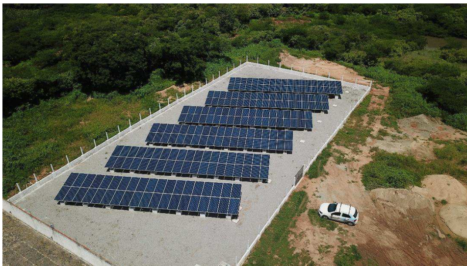
Figura 20 – Usina fotovoltaica de 74,1 kWp na cidade de Cajazeiras-PB.
