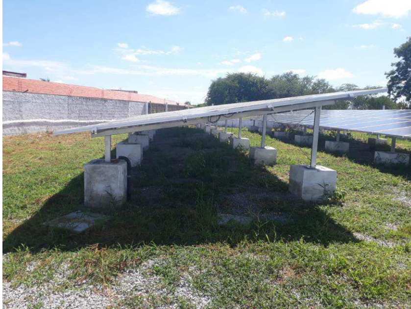
Figura 29 – Vista lateral das estruturas da UFV
