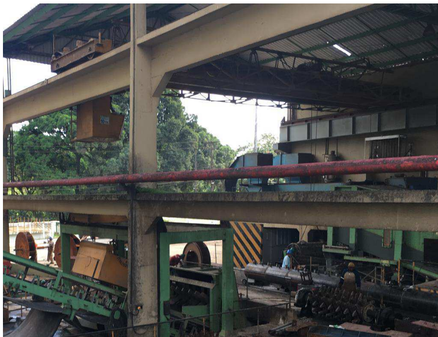
Figura 30 - Ponte rolante em funcionamento pleno na Usina Trapiche.
