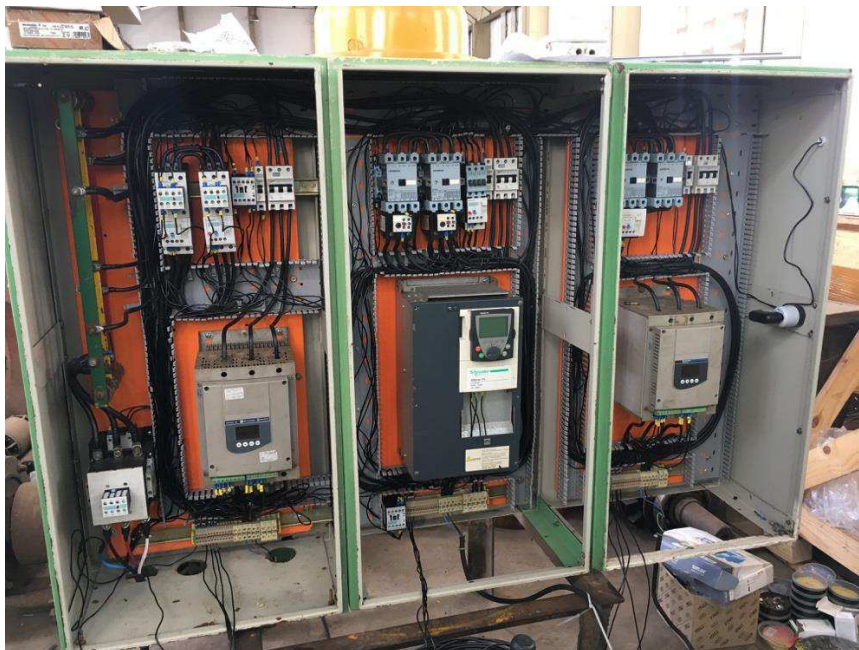
Figura 25 - Novo quadro elétrico para a ponte rolante.
