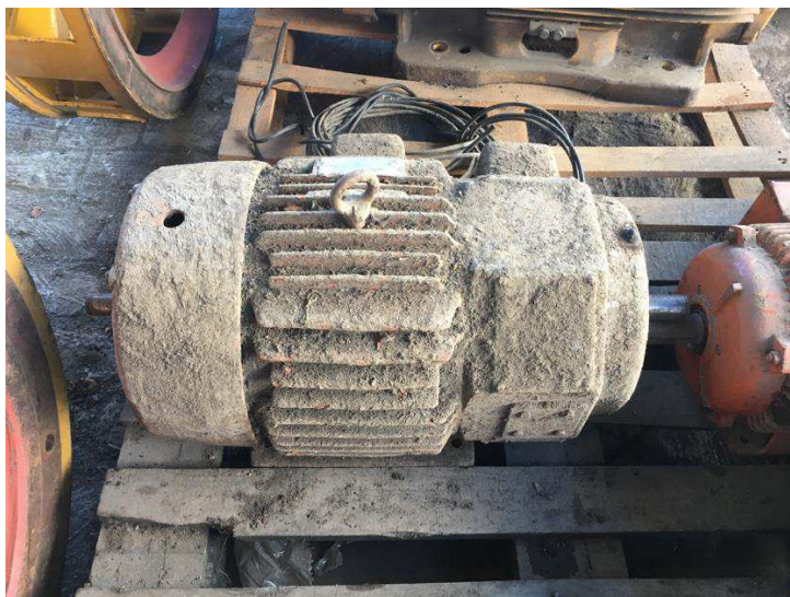
Figura 23 - Motor de rotor bobinado da movimentação longitudinal.
