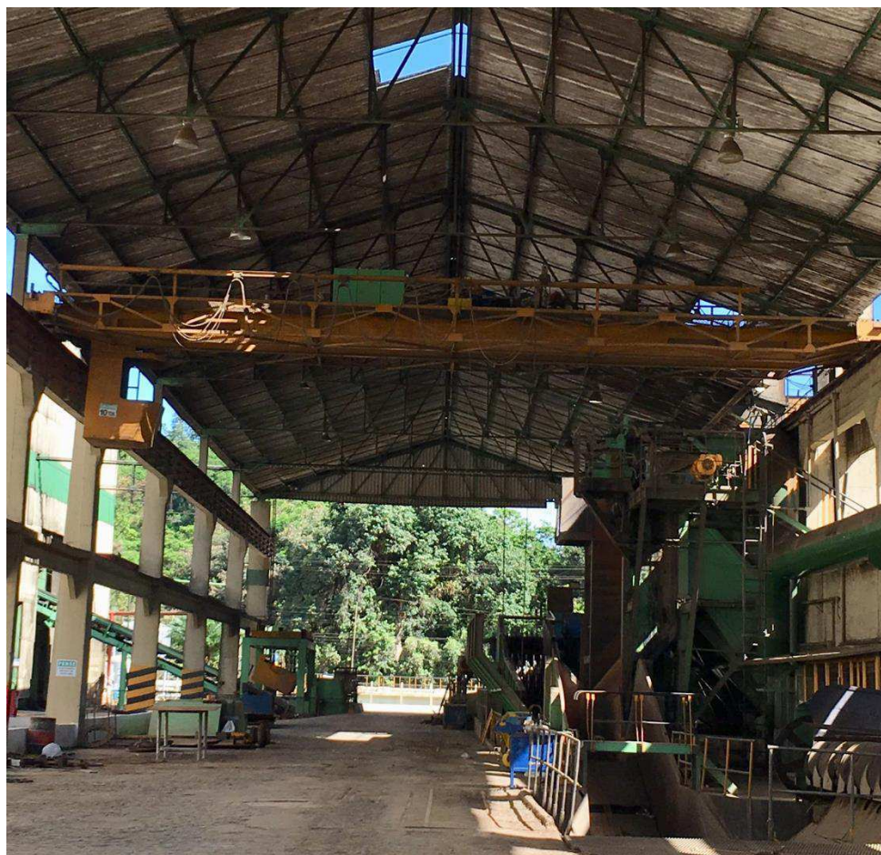
Figura 20 - Ponte Rolante Casa de Cana Coberta.
