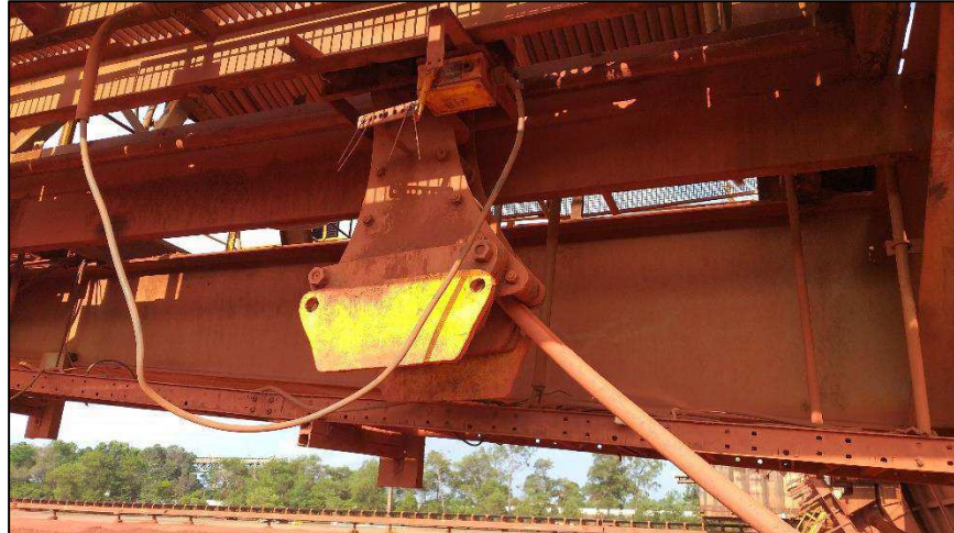
FIGURA 47 - PÊNDULO DO ENROLADOR DE CABOS.
