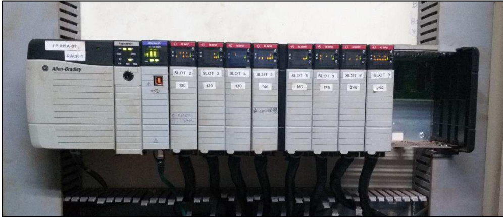
FIGURA 43 - CLP CONTROLOGIX DA ALLEN BRADLEY.
