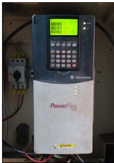
FIGURA 46 - DRIVE INVERSOR POWERFLEX700 DO ENROLADOR DE CABOS.
