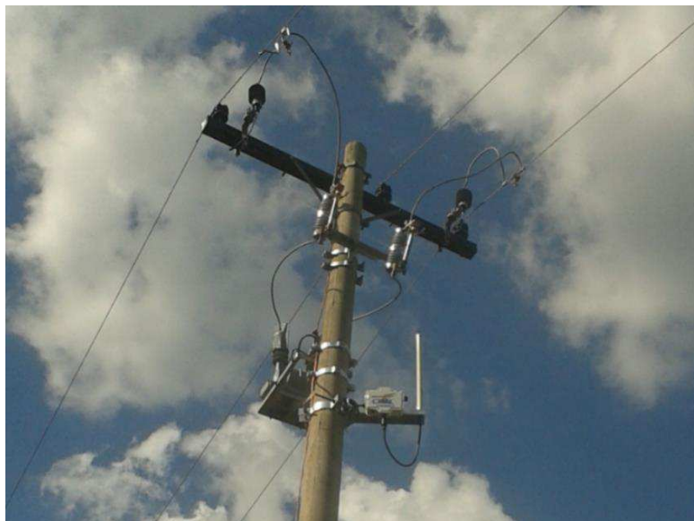
Figura 13 - Componente de repetição do sinal RF da rede Mesh, instalado em poste.
