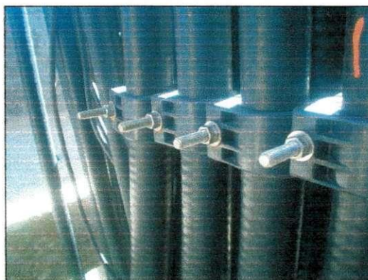
Fig. 05: Prensa Cabos (Fonte: Vistoria Claro)
