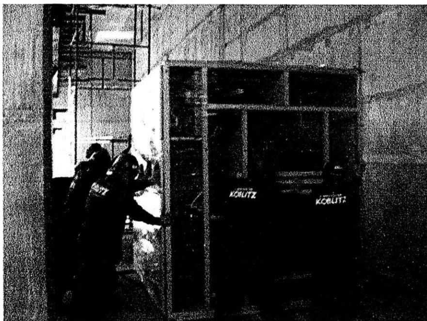
Figura 10 - Painel de Proteção do Gerador
