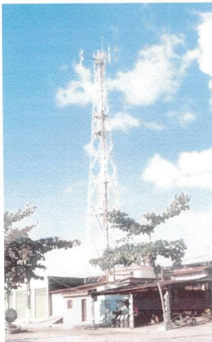
Figura 4 – Torre instalada à rua Doutor Vasconcelos, Alto Branco.
