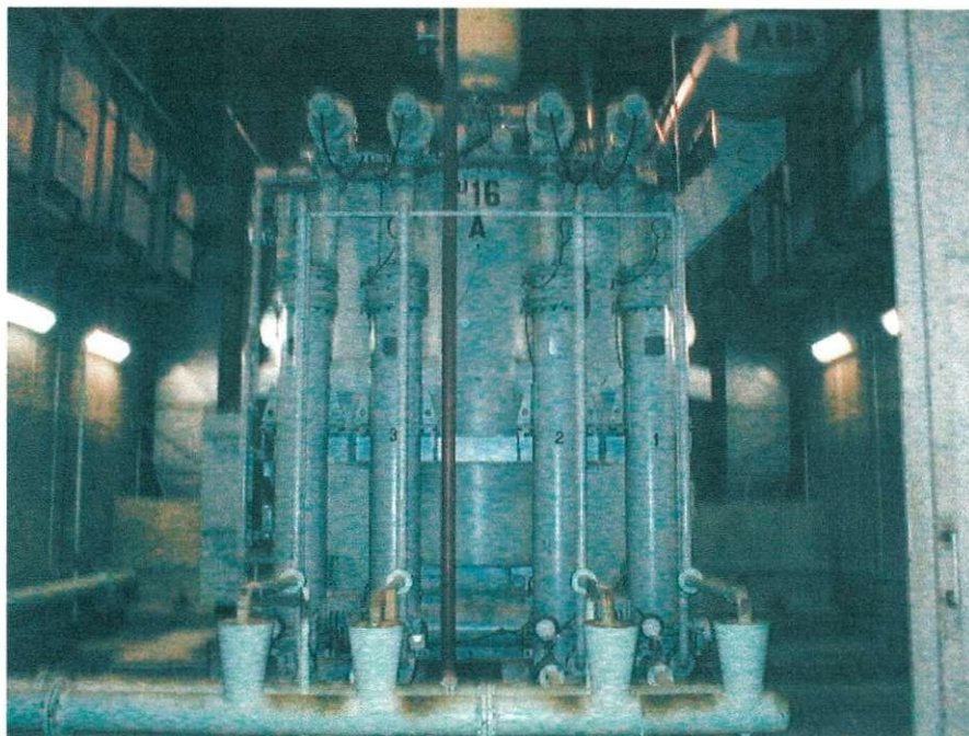
Figura 4- Transformador elevador (18KV / 500KV).
