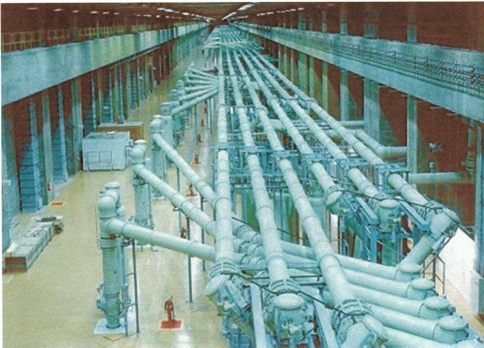
Figura 5: Subestação isolada a gás (GIS).
