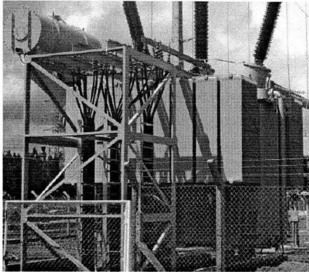
Figura 2.13 – Transformador Elevador da UTE Muricy I
