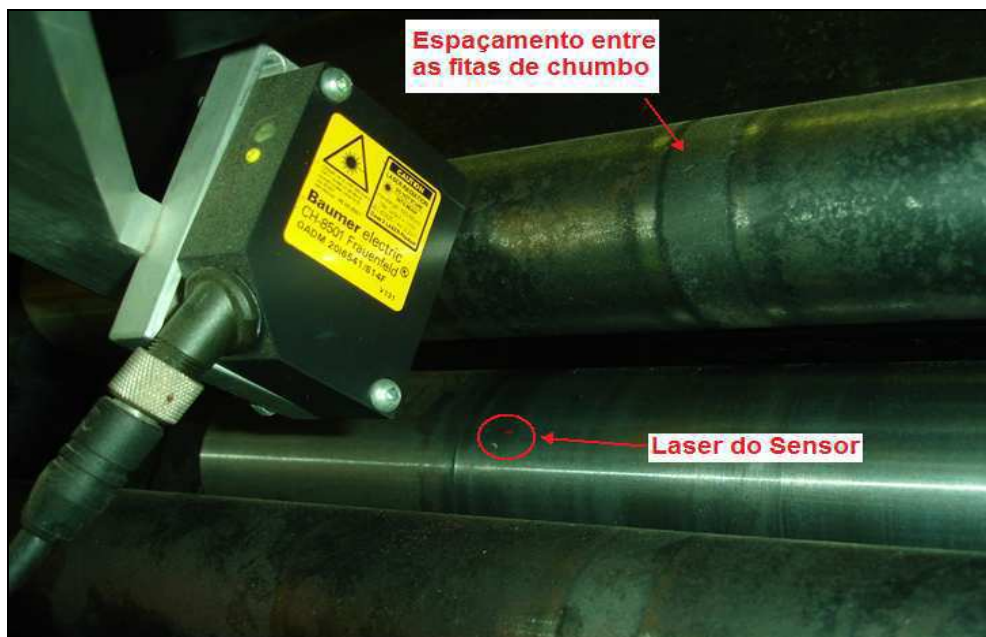
Figura 6.3.4 – Espaçamento das Fitas de Chumbo e o Laser do Sensor
