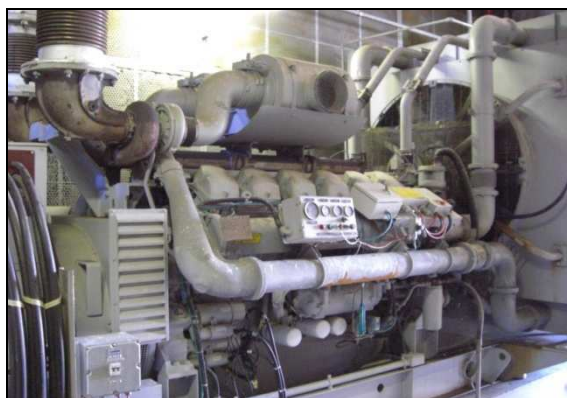
Figura 6.5.2 – Gerador de Emergência
