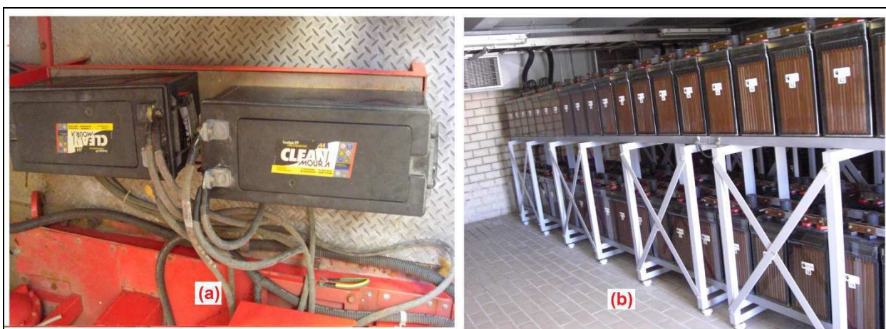
Figura 6.5.1 – (a) Banco de Baterias Moura Clean 12MF220; (b) Banco de Baterias Saturnia 23ANFM1750
