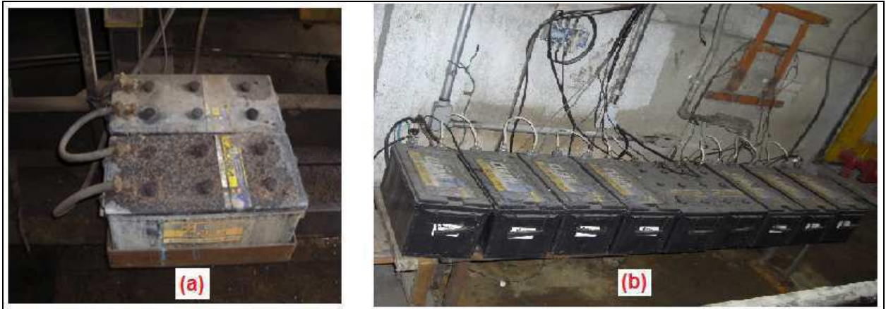
Figura 6.4.2 – (a) Banco de 24V com Baterias Moura com Prata MP150BD; (b) Banco de Baterias de 110V com Baterias Moura Clean 12MF150
