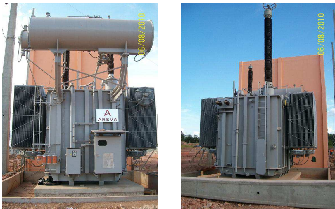
Figura 6: Transformadores de Força da SE Miranda II.
