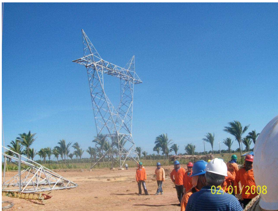
Figura 5: Torre de Ancoragem 4, tipo FTQ1, P.Dutra C1.
