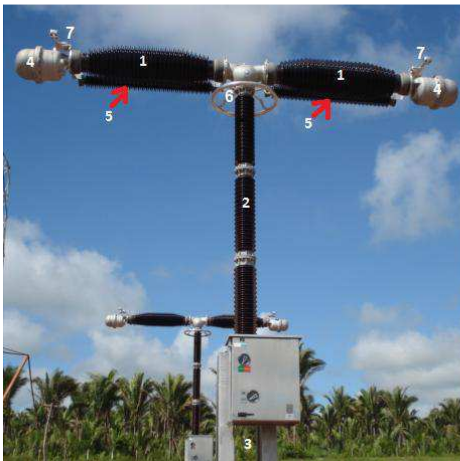
Figura 15: Disjuntor Areva GL 317D 500 kV.
