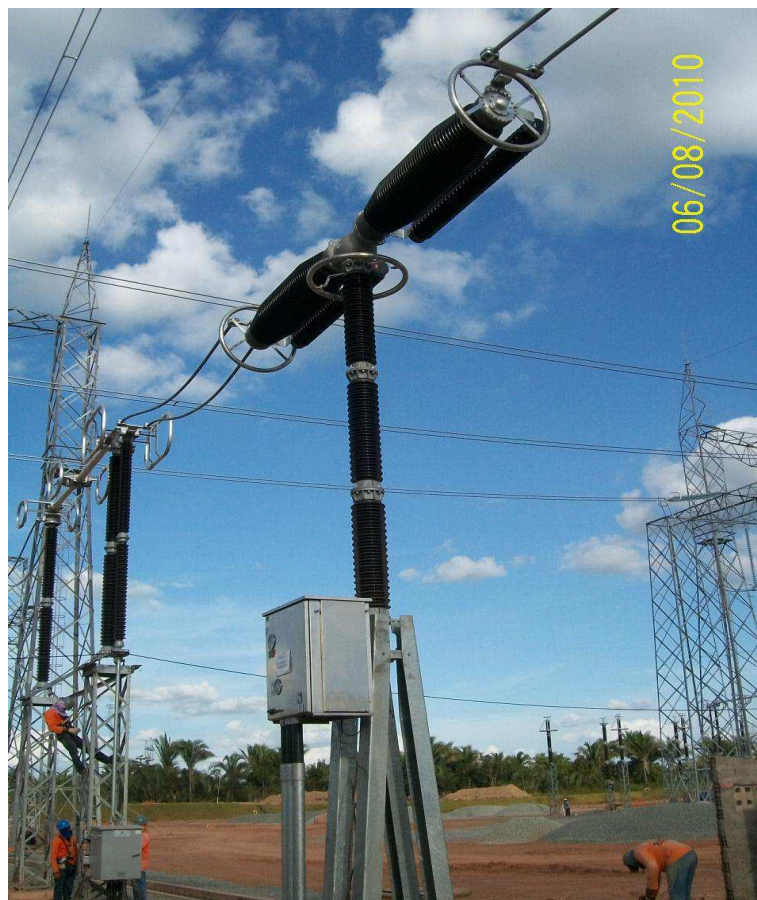
Figura 33: Disjuntor Areva GL 317.
