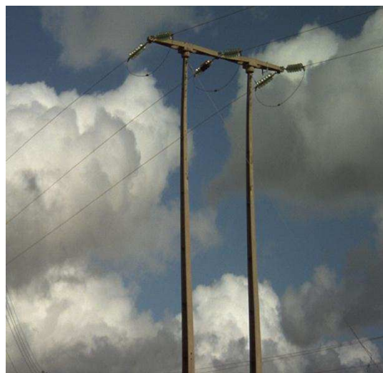
Figura 3 - Fotografia de Estrutura H-AL Circuito Simples
