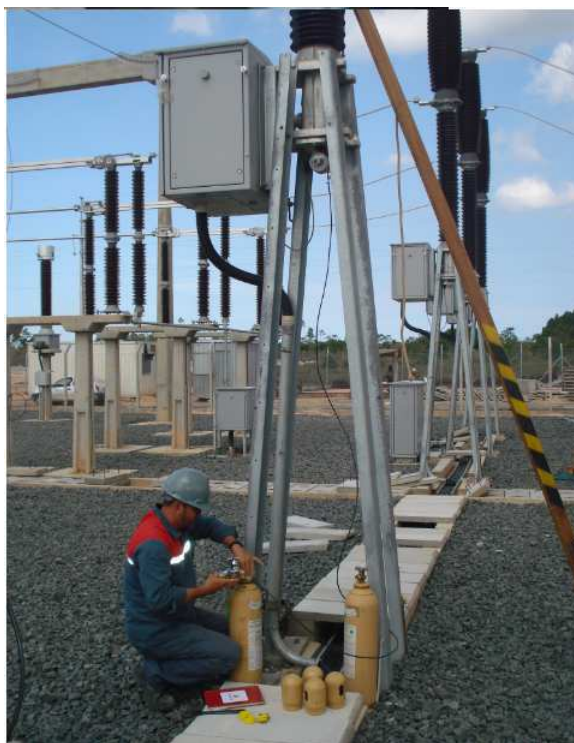
Figura 30: Procedimento de preenchimento de SF6 nos disjuntores
