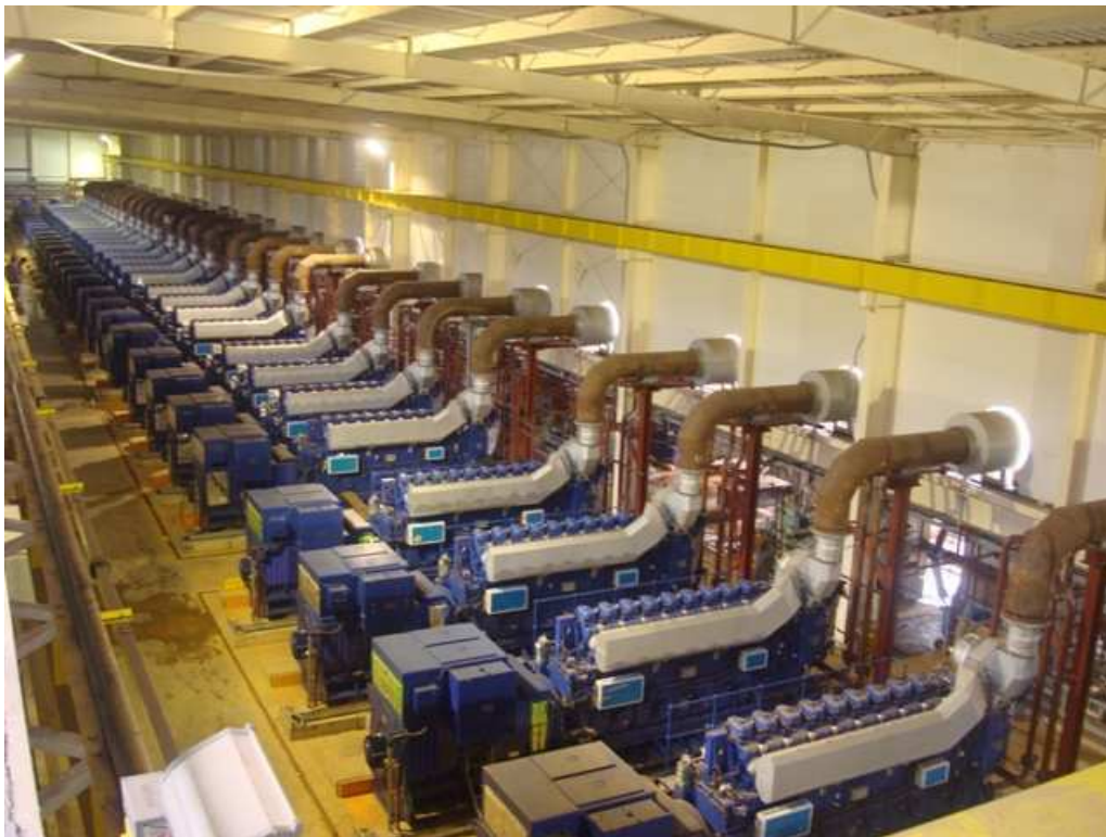
Figura 2: Grupo de geradores de um dos lados da UTE Arembepé
