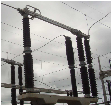
Figura 27: Chave seccionadora Areva
