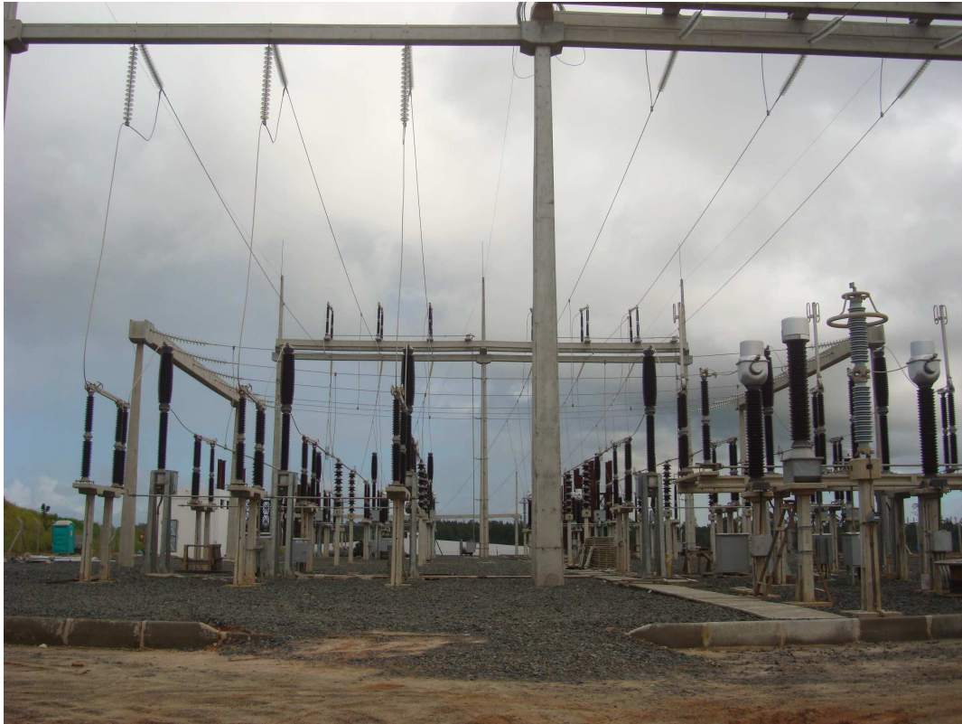
Figura 13: Subestação elevadora da Arembepe Energia
