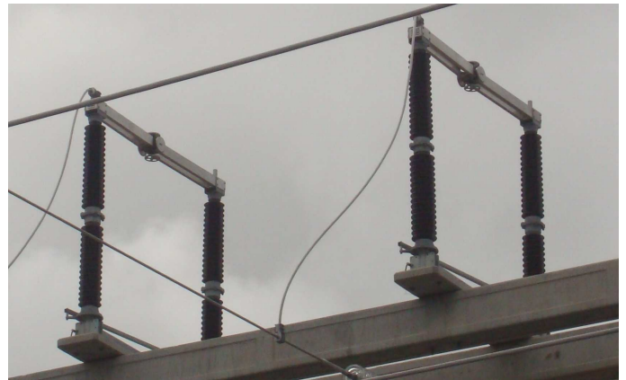
Figura 28: Chave seccionadora de by-pass
