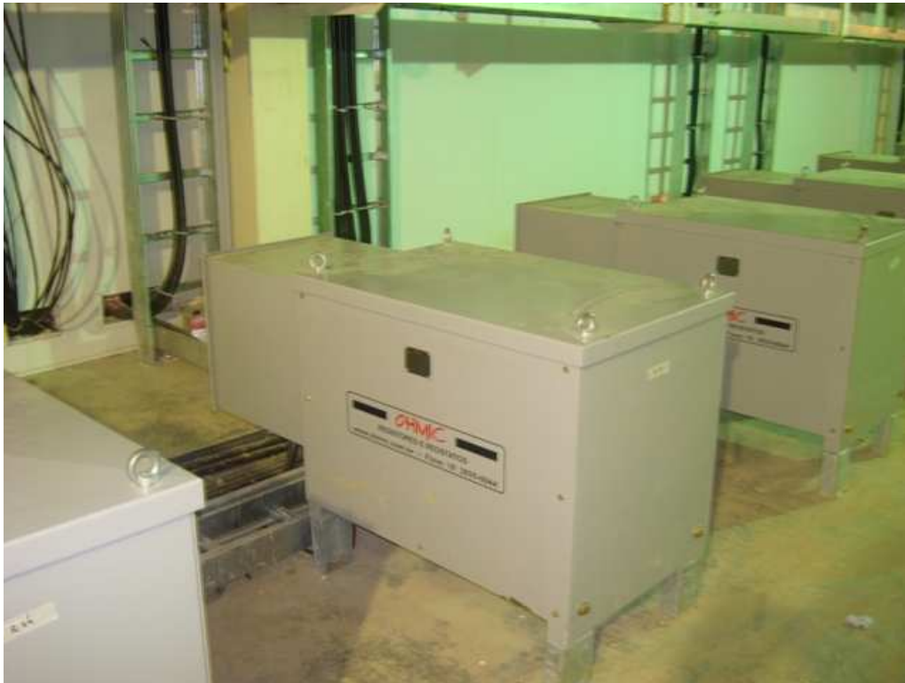
Figura 7: Resistor de aterramento de 762,1\Omega
