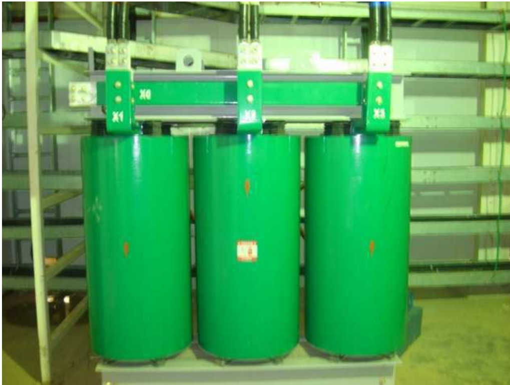
Figura 9: Transformador de 1,5 MVA utilizado para serviços auxiliares
