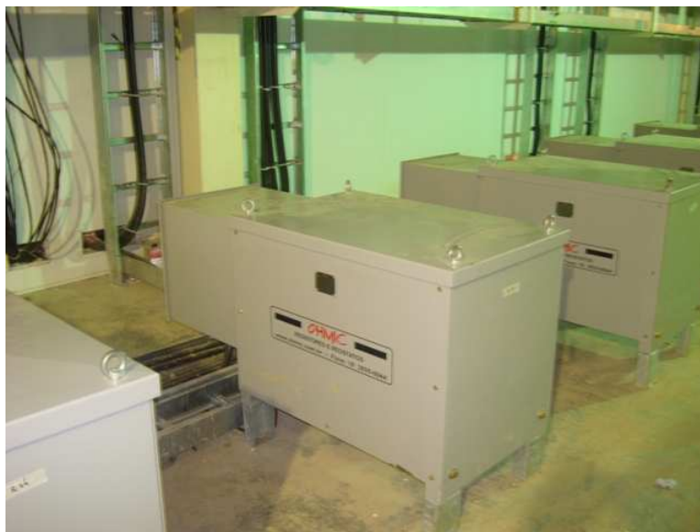
Figura 20: Resistor de aterramento
