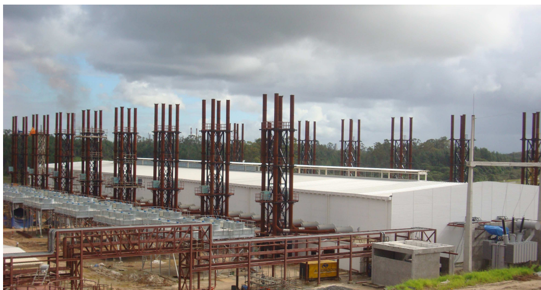
Figura 1: Usina Termoelétrica Arembepe Energia
