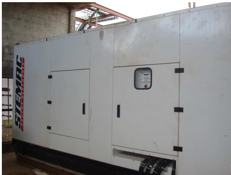
Figura 10: Grupo gerador de emergência Stemac 750 kW
