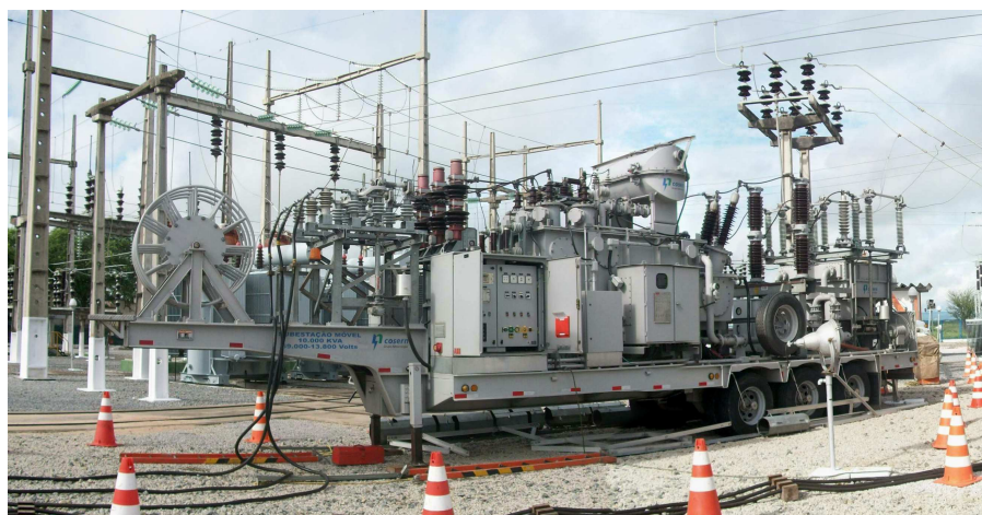
Figura 19 - Subestação móvel (10 MVA, 69 kV-13,8 kV) da Cosern cedida à Chesf para realização da intervenção
