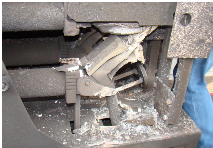
Figura 24 - Disjuntor após ocorrência do curto-circuito.
