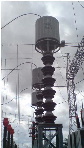
Figura 3 – Bobina de Bloqueio na SE CGD
