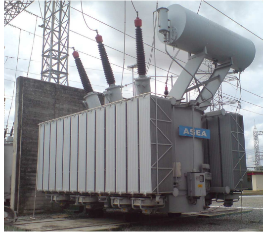
Figura 7 - Transformador 04T3 na SE CGD
