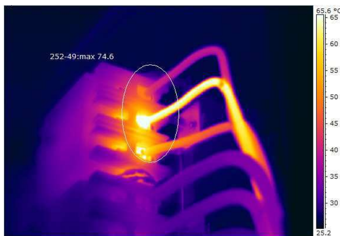
Figura 26 – Ponto Quente na Central de Refrigeração dos Serviços Auxiliares da SE NTD
