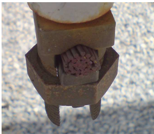
Figura 28 - Ferrugem no cabo de aterramento dos disjuntores
