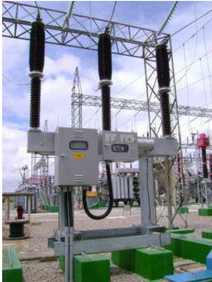
Figura 7 – Disjuntor Camargo Corrêa tipo 120-SFM-40E (Novo 13D1 da SE CGD)
