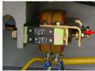
Fig. 24 – Bobinas de abertura do 13D1
