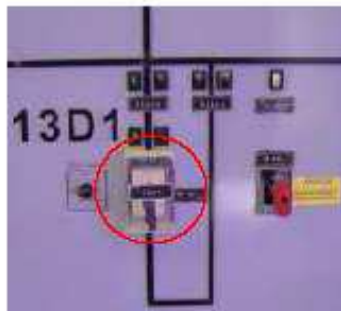
Fig. 22 – Painel de comando do 13D1
