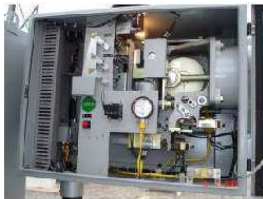
Fig. 2 – Armário do Mecanismo Operacional
