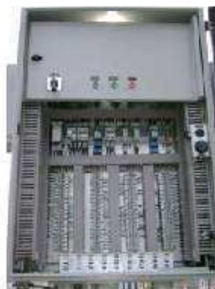
Fig. 3 – Armário de Comando e Controle
