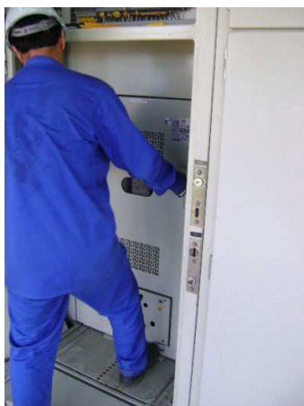
Figura 3.3 – Disjuntor sendo sacado de dentro do cubículo
