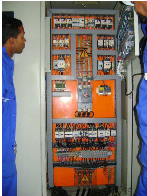
Figura 3.7 – Visão de um painel de comando
