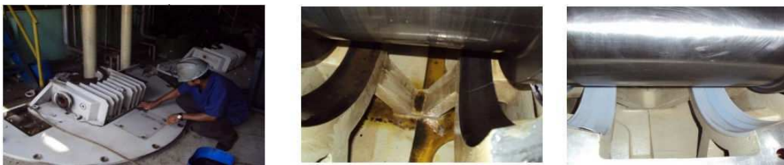
Figura 3.23 – Limpeza das tampas dos mancais (esquerda) e do tanque de óleo ( centro e direita)
