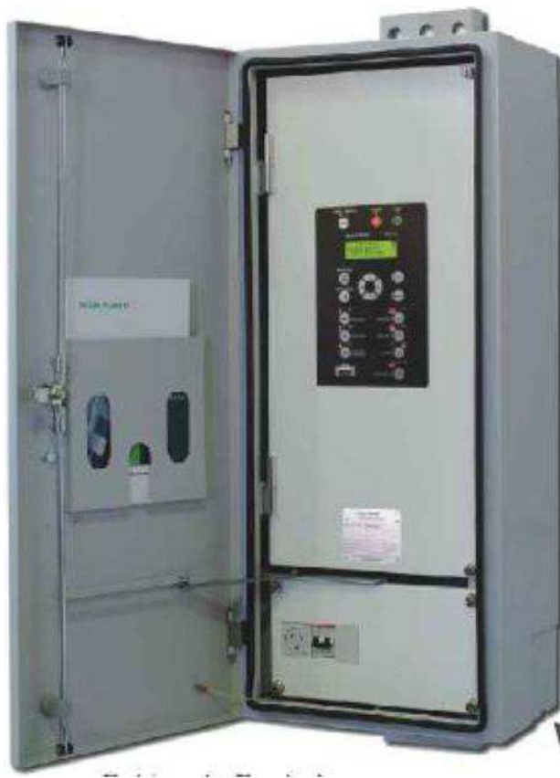
Figura 9: Cubículo de controle Noja. Fonte: Energisa Paraíba.
