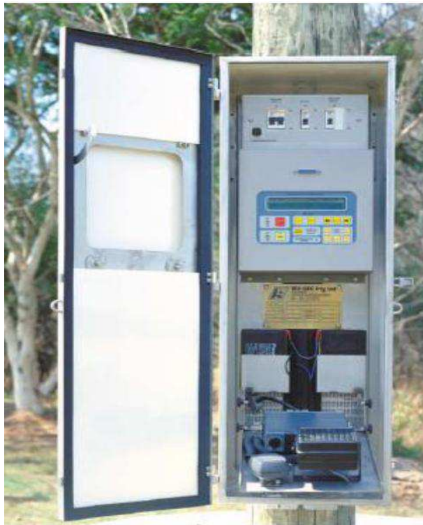
Figura 8: Cubículo de controle Nulec. Fonte: Energisa Paraíba.
