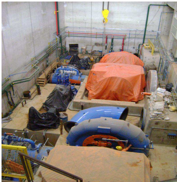
Figura 7(b): Fotografia da casa de força de Barra da Paciência.
