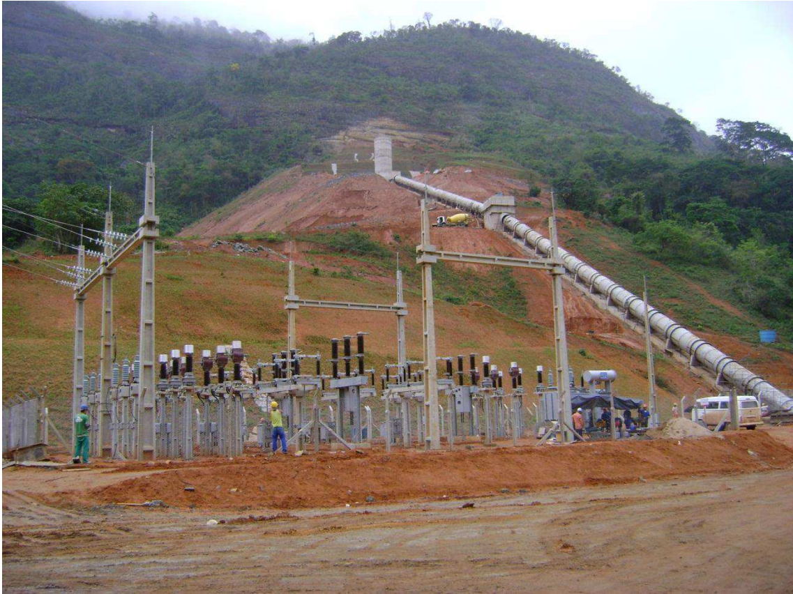
Figura 16. Vista da Subestação da PCH Barra da Paciência.
