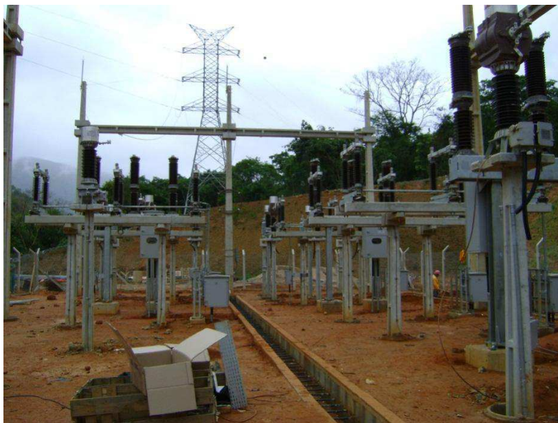
Figura 15 . Foto da Subestação da PCH Barra da Paciência
