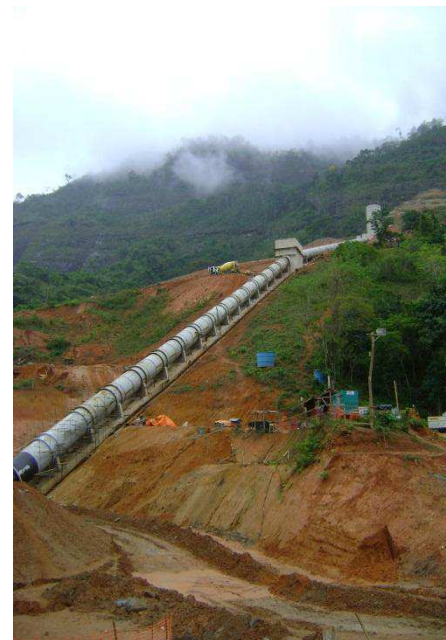
Figura 6: Foto do conduto forçado.
