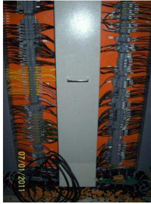
Figura 29. Foto da disposição dos cabos interligados no painel de comando do painel QPC-U2 da PCH Barra da Paciência .
