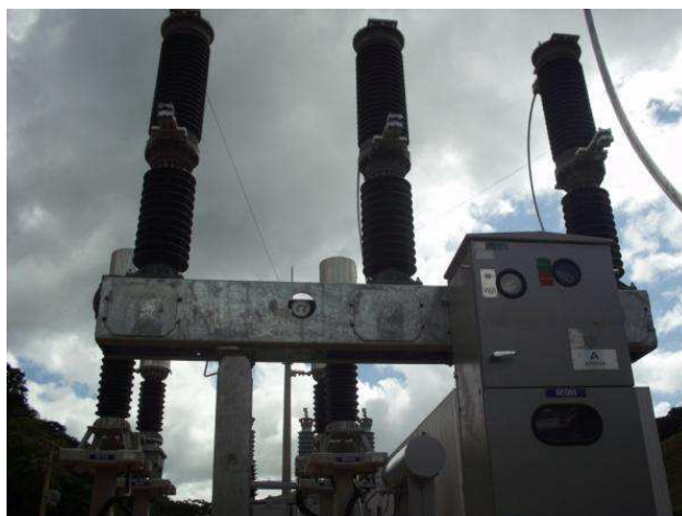
Figura 20. Fotografia de um Disjuntor da SE Barra da Paciência .
