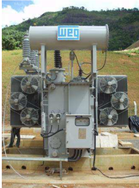
Figura 22. Foto do transformador elevador da SE Barra da Paciência.
