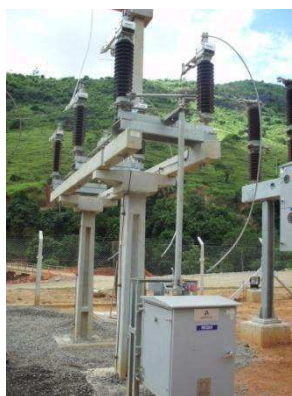
Figura 21. Fotografia da chave seccionadora da SE Barra da Paciência.
