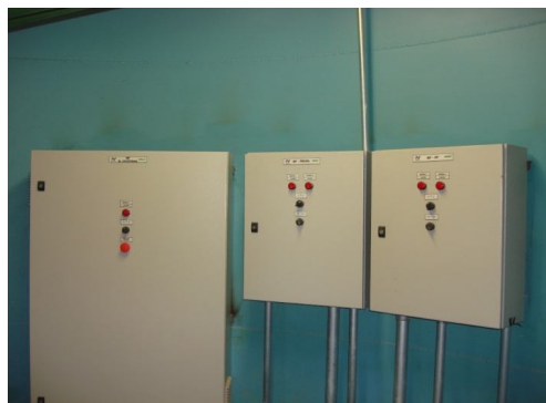
Figura 9 - Quadros da casa de bombas.
