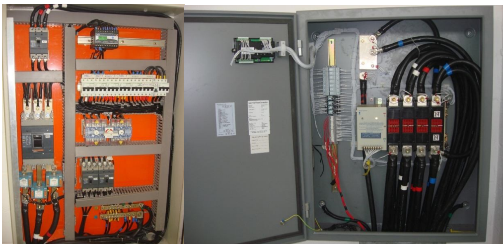
Figura 14 - Quadro de Distribuição Parcial (QDP) 17 e quadro do gerador da Cummins.
