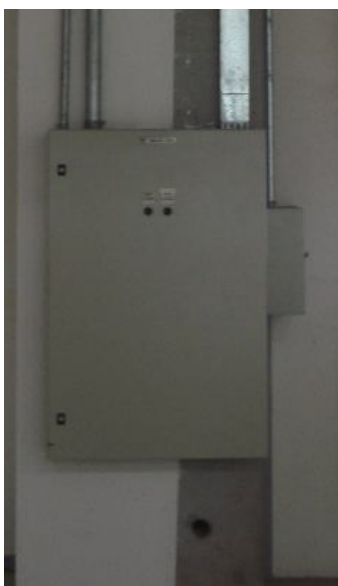
Figura 7 - Quadro de Distribuição de Luz e Força (QDL) 01.
