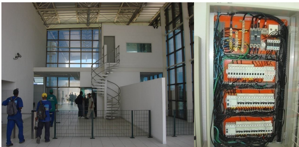
Figura 16 - Guarita e Quadro de Distribuição de Luz e Força (QDL) 03.
