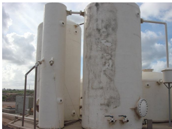
Figura 3 – Estação de Tratamento de Efluentes (ETE).
