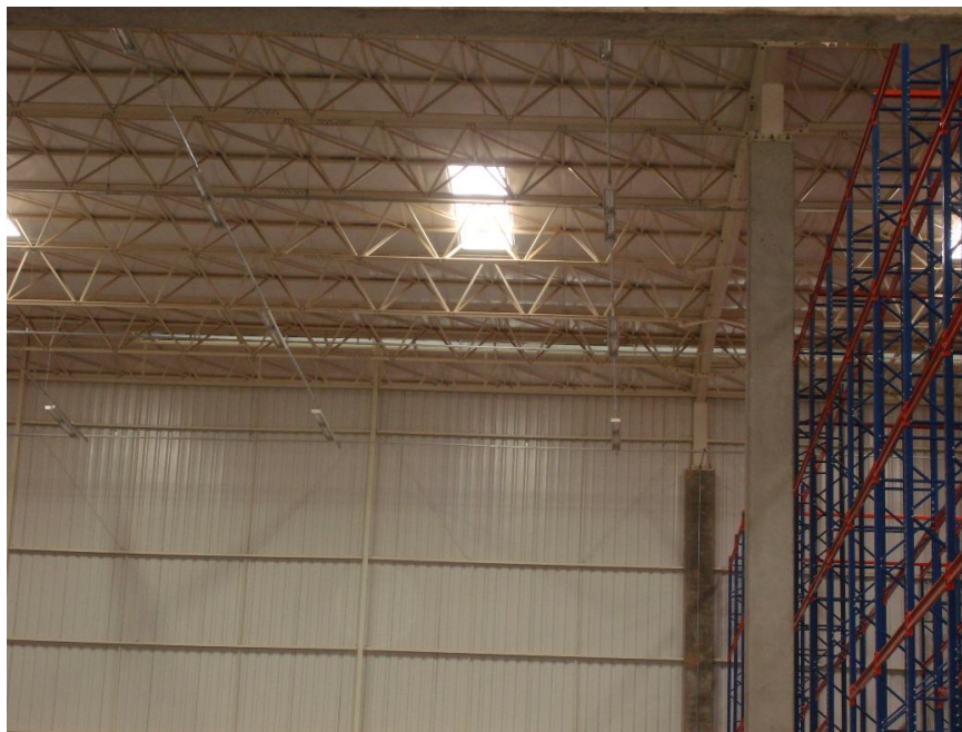
Figura 30 – Realocação da posição das luminárias de 2 x 54 W no módulo 9.
