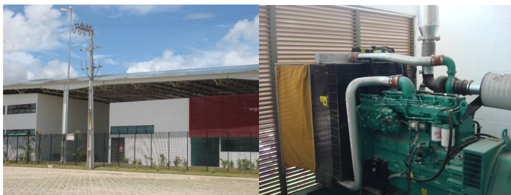
Figura 12 - Entrada do PE da subestação e gerador da Cummins.
