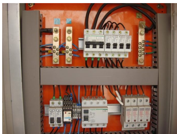
Figura 4 - Quadro de Distribuição de Luz e Força (QDL) 02 da ETE.
