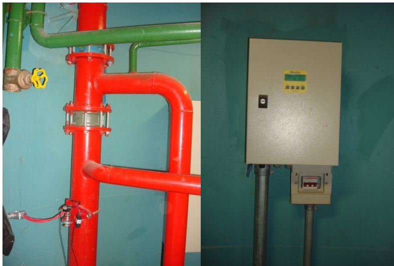
Figura 25 – Adaptação na tubulação de água e quadro de força da bomba do poço.
