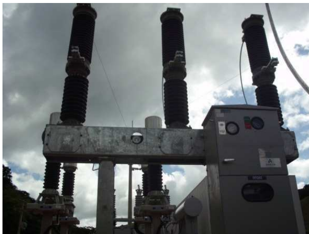
Figura 9. Foto de um disjuntor.
