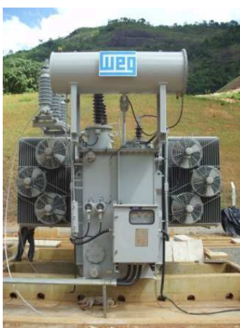
Figura 11. Foto do transformador elevador.
