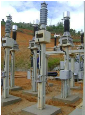
Figura 6. Foto dos pára-raios.
