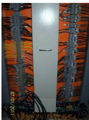
Figura 19. Disposição dos cabos interligados nos painéis.
