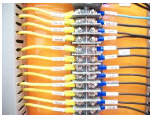
Figura 17. Terminal tipo olhal e anilhas nos cabos.
