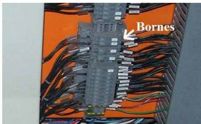
Figura 20. Cabos interligados aos bornes nos painéis.
