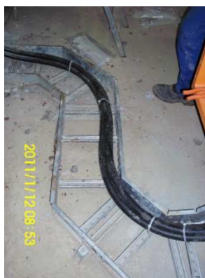
Figura 16. Trifólio dos cabos de média tensão.
