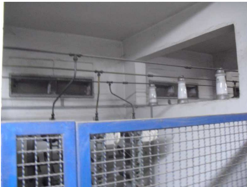
Figura 8. Barramento tipo vergalhão de cobre
