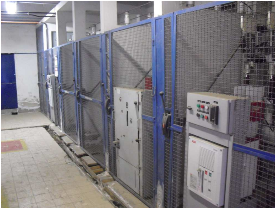
Figura 5. Baias de distribuição para tensão de 13,8 kV.
