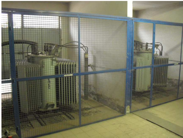
Figura 4. Transformadores de 750 kVA
