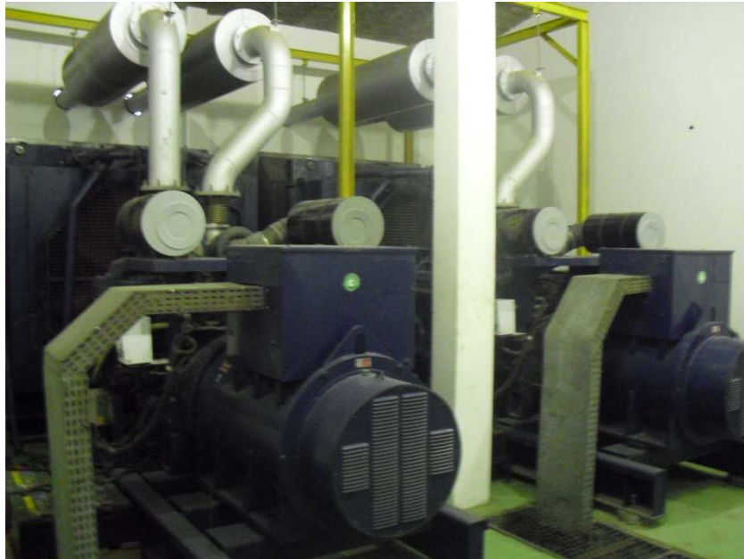
Figura 9. Grupos geradores de 2,5 MVA de potência aparente.
