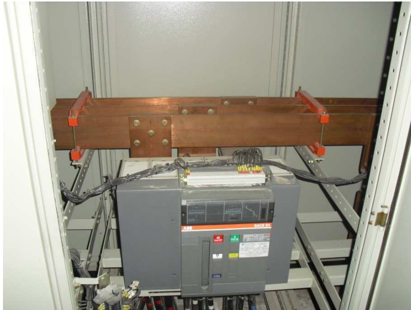
Figura 10. Barramento de baixa tensão dos geradores.
