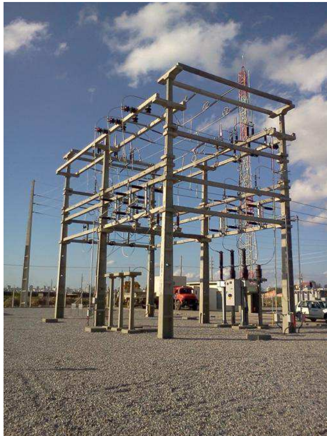
Gaiola de 69kV
