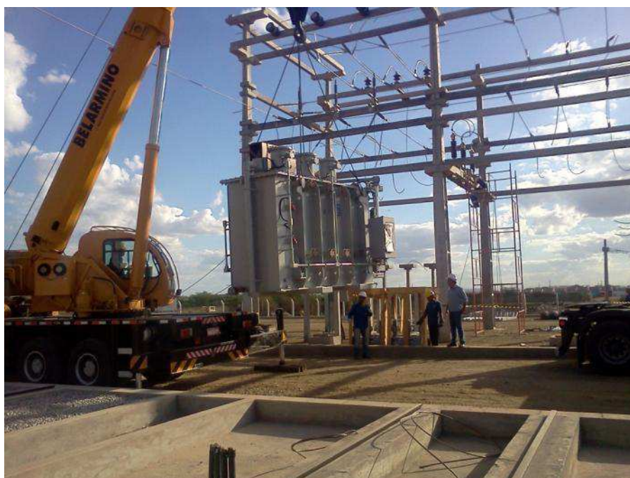
Chegada do transformador de força
