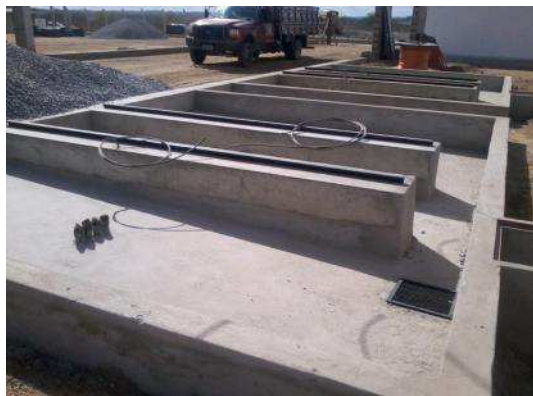
Figura 4- Base do trafo e caixa coletora.
