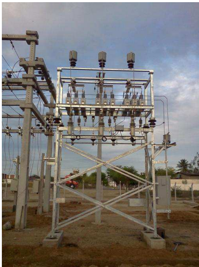
Banco de capacitores
