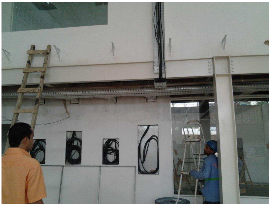
Figura 14 - Caixas de passagem e eletrocalhas.
