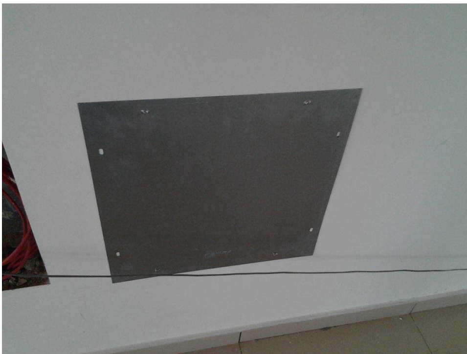
Figura 18 - Caixa de passagem fechada.
