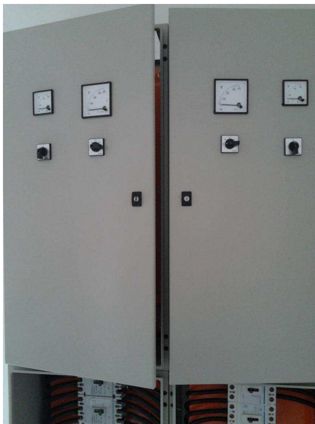
Figura 26 - Armário com portas fechadas com medidores de tensão e corrente.
