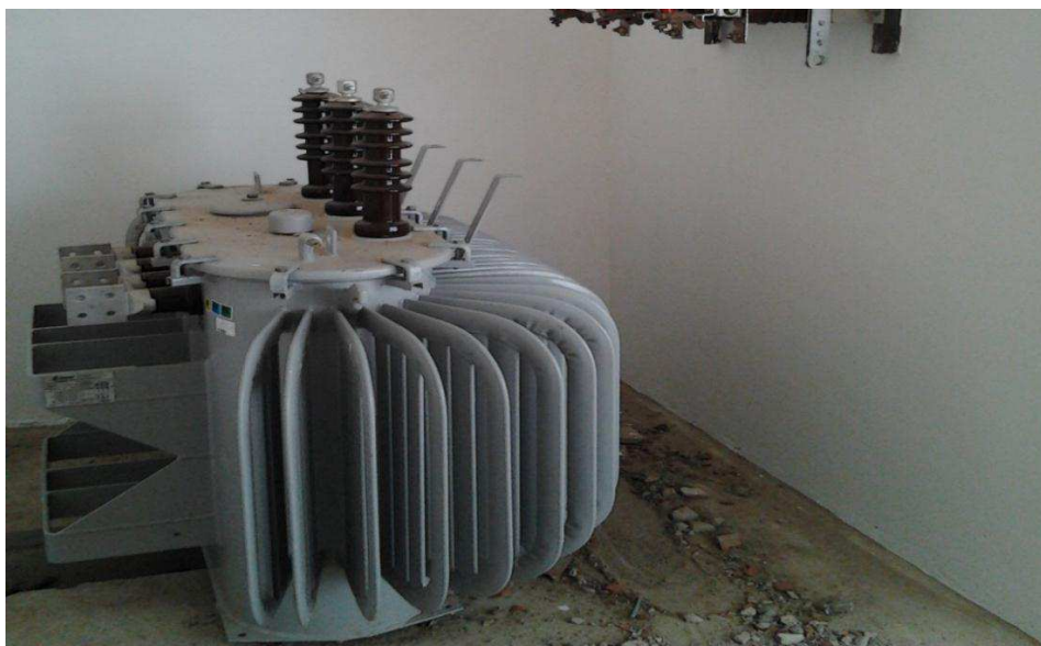
Figura 19 - Transformador 300 kVA 13,8 kV/380/220, 60 Hz utilizado na subestação.
