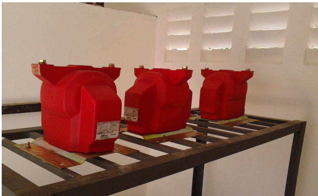
Figura 21 - Transformadores de potencial.
