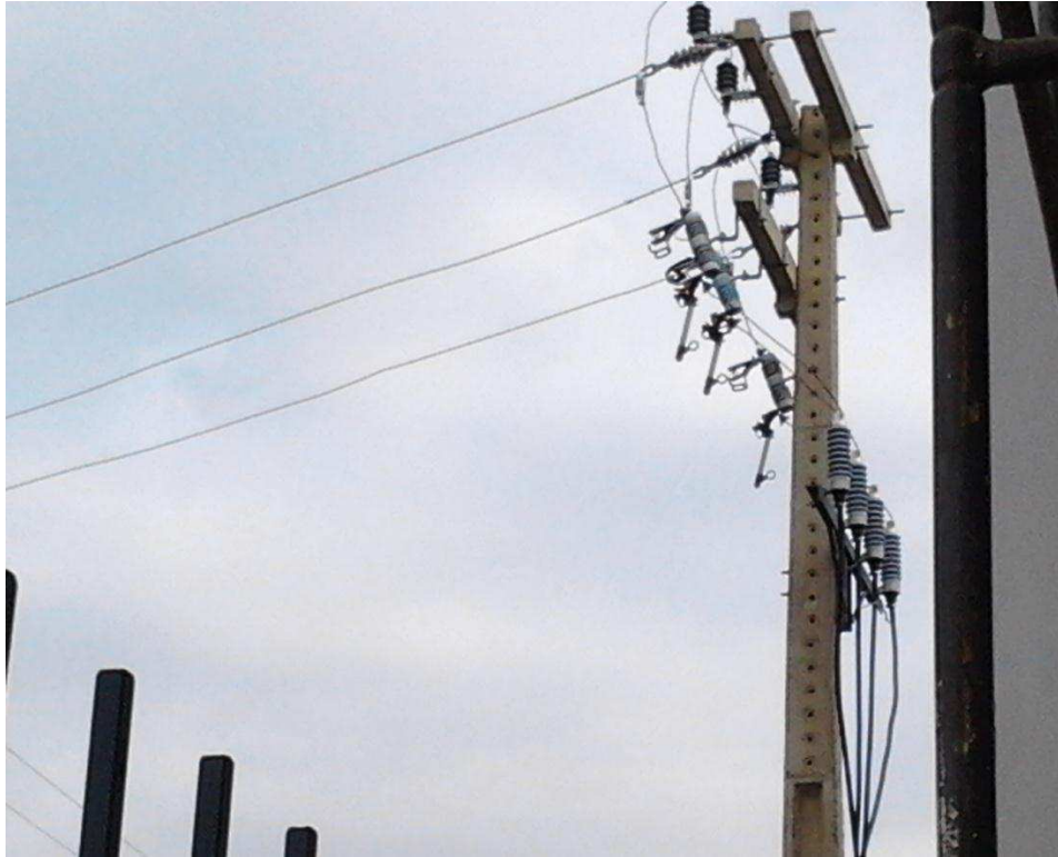
Figura 25 - Ponto de entrega da rede de distribuição urbana.
