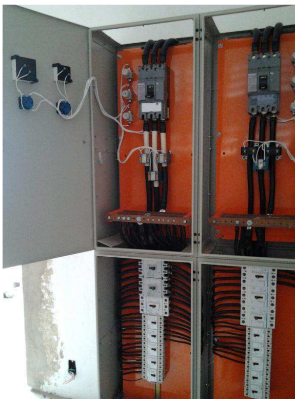
Figura 27 - Armário com portas abertas mostrando disjuntores, TP's, TC's e fusíveis.
