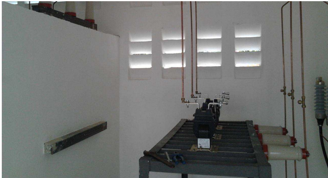
Figura 22 - Transformadores de corrente
