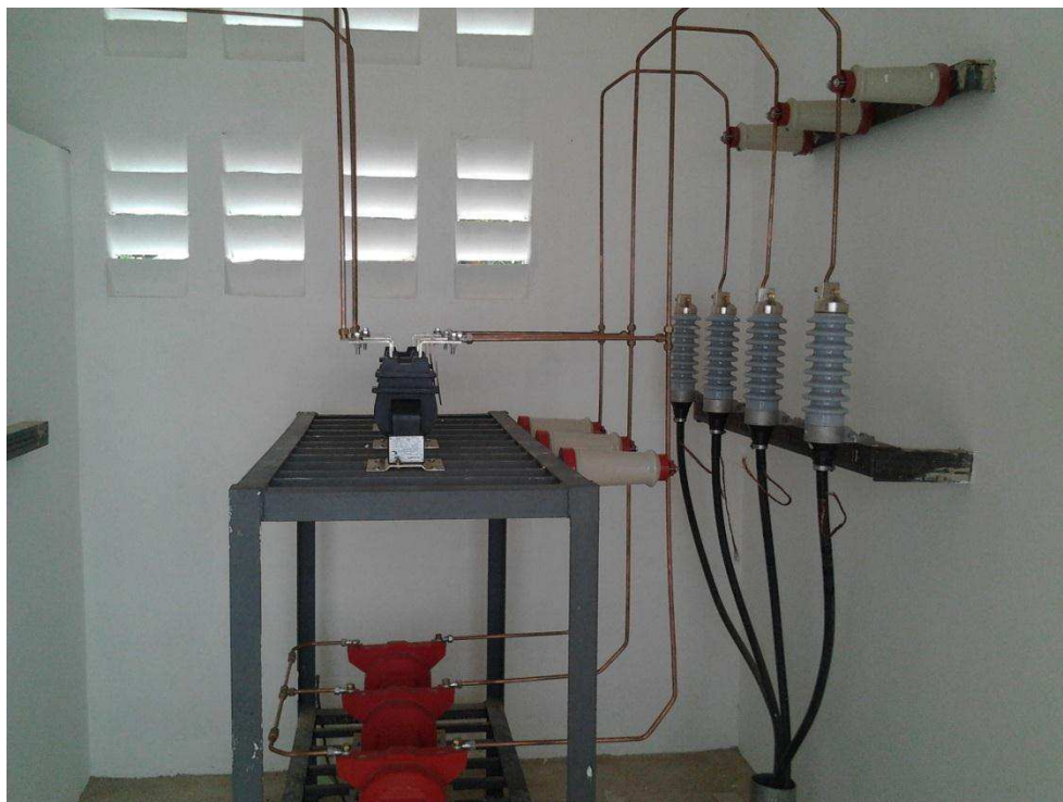
Figura 23 - TP's e TC's devidamente instalados.
