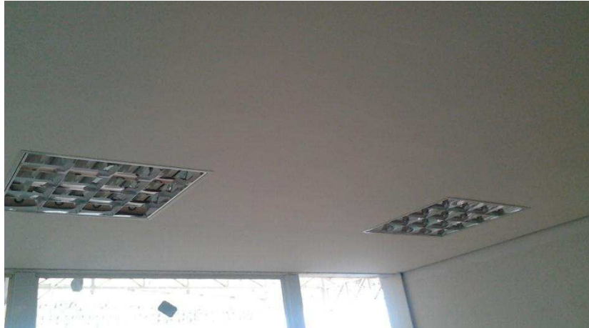
Figura 3 - Luminárias já instaladas.
