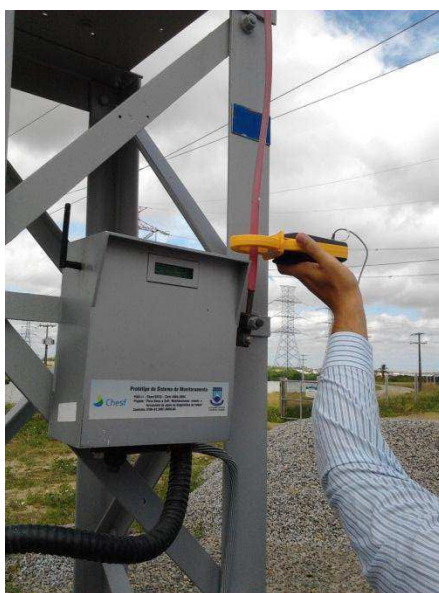
Figura 19 - Equipamento para monitoramento de corrente de fuga em para-raios ZnO
