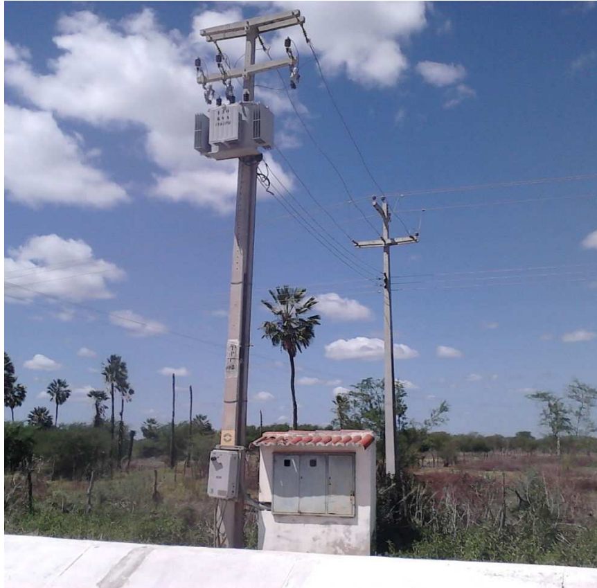
Figura 9. Subestação ao tempo para alimentação de UB's em campo.
