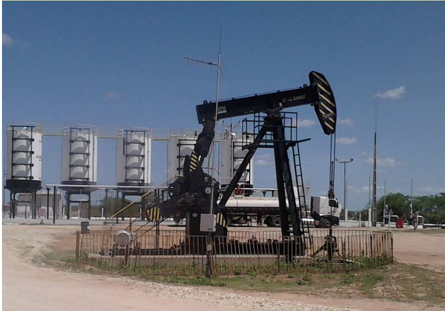
Figura 11. Unidade bombeadora terrestre em campo.
