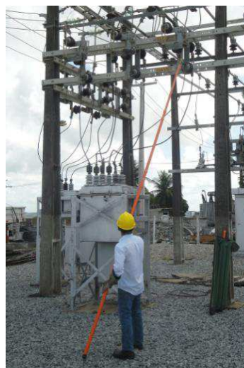
Figura 19 - Operador abrindo chave seccionadora do religador
