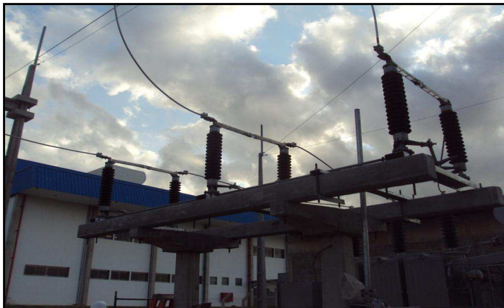
Figura 4 - Chave seccionadora sem lâmina de terra
