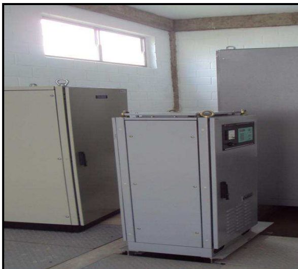
Figura 15 – Painel do Retificador fixado
