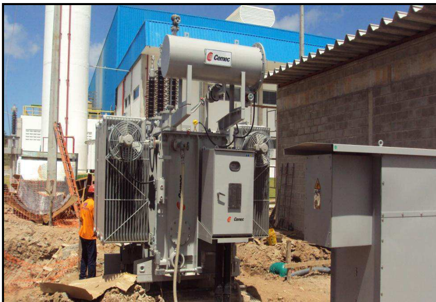
Figura 10 - Transformador da SE – AMCOR
