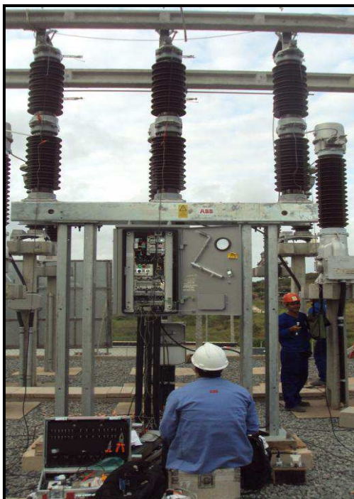
Figura 9 - Disjuntor da SE-AMCOR
