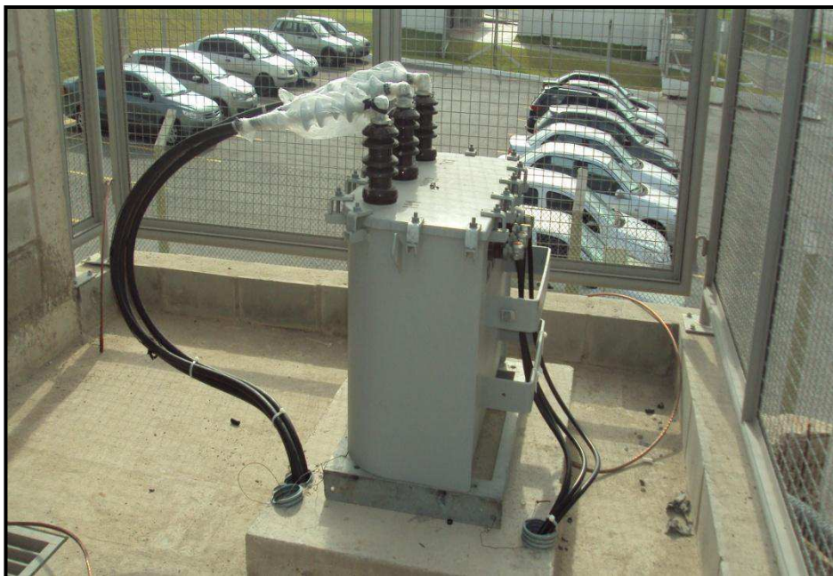
Figura 12 - Transformador de Serviço Auxiliares
