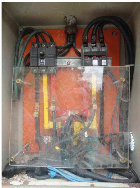
Figura 4. Antigo quadro de medição do bloco de Odontologia.
