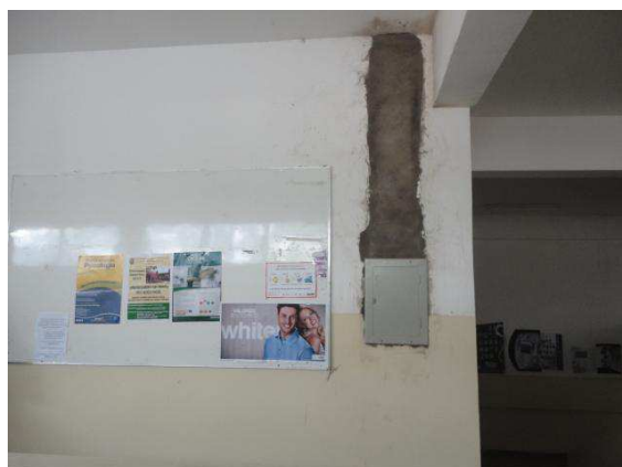
Figura 5. Quadro de medição instalado no 1º andar do bloco de Odontologia.
