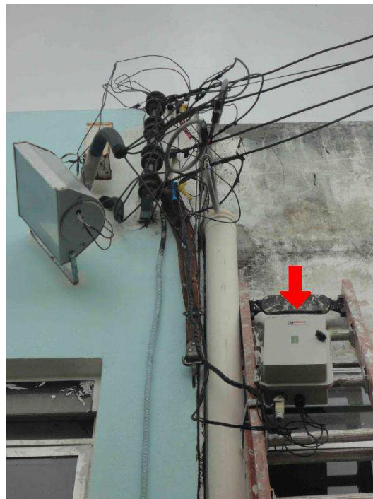
Figura 1. Analisador PowerNET P-600 instalado.
