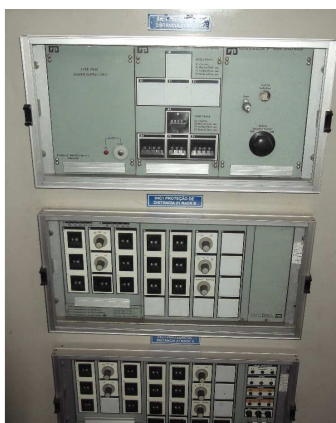
Figura 24: Vista frontal do painel da proteção existente.
