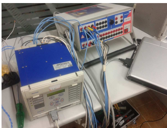
Figura 19: Conexão da mala de teste com o relé P441.
