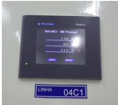
Figura 27: Display remoto localizado na Sala de Comando.
