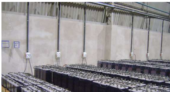
Figura 10. Vista da infraestrutura em leitos e eletrodutos para conexão dos bancos. Fonte: Imagem própria, Brasil, 2012.
