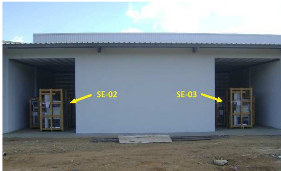
Figura 33. Imagem dos abrigos das Subestações 02 e 03 da UN-08. Fonte: Imagem própria, Brasil, 2012.
