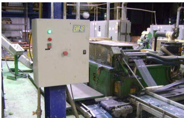
Figura 11. Foto de parte do transportador de rebarbas e quadro de comando. Fonte: Imagem própria, Brasil, 2012.
