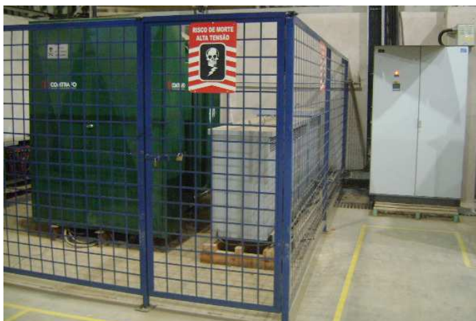
Figura 7. Vista frontal do transformador blindado e da SE provisória com QGBT. Fonte: Imagem própria, Brasil, 2012.
