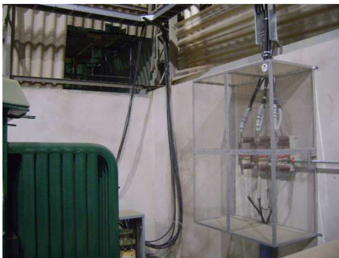
Figura 8. Foto da chave seccionadora para o transformador. Fonte: Imagem própria, Brasil, 2012.
