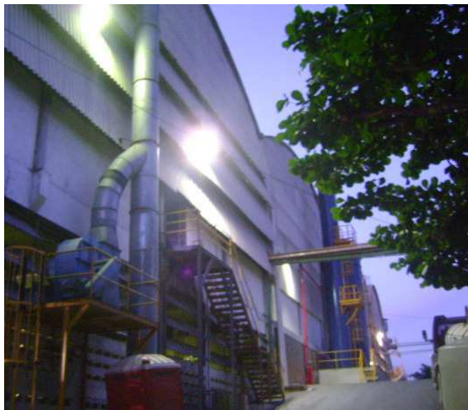
Figura 27. Foto de refletores instalados por trás do galpão da UGB-01. Fonte: Imagem própria, Brasil, 2012.
