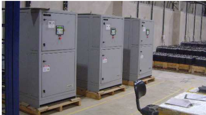
Figura 9. Foto dos retificadores instalados para a formação de baterias. Fonte: Imagem própria, Brasil, 2012.
