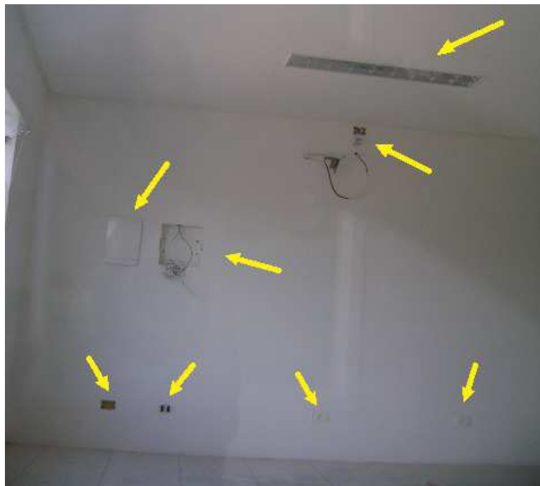
Figura 22. Vista dos quadros, iluminação e tomadas na Galeria. Fonte: Imagem própria, Brasil, 2012.
