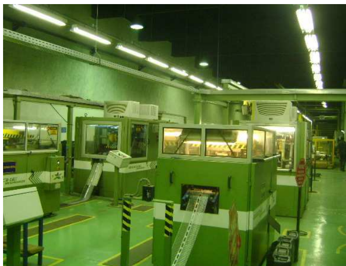
Figura 28. Foto de luminárias para lâmpadas fluorescentes tubulares na Roche. Fonte: Imagem própria, Brasil, 2012.
