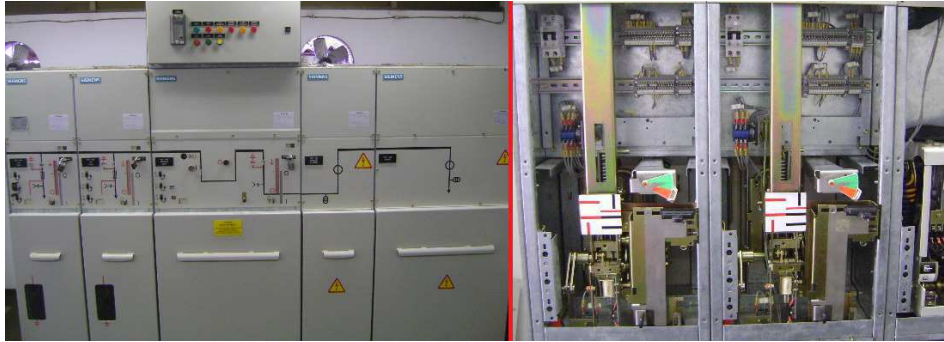
Figura 40. Vistas do painel Siemens Simoprime fechado e aberto. Fonte: Imagem própria, Brasil, 2012.
