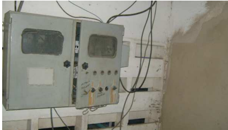
Figura 29. Vista de quadro relocado devido à risco de queda da parede por acidente.
