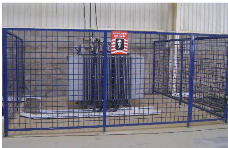
Figura 15. Foto do transformador de 2.000 kVA na SE provisória. Fonte: Imagem própria, Brasil, 2012.
