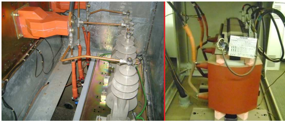
Figura 41. Vistas dos TC's e TP's e transformador Siemens a seco de 75 kVA. Fonte: Imagem própria, Brasil, 2012.
