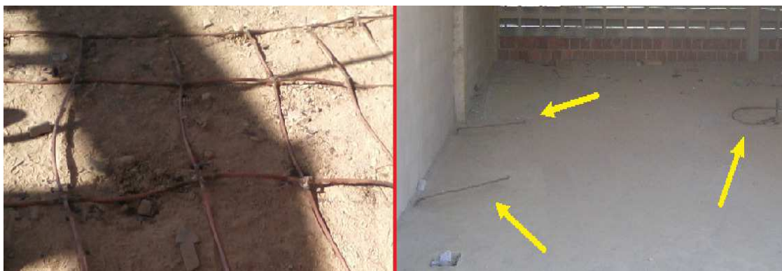
Figura 20. Vista da malha finalizada e posterior concretamento com os rabichos. Fonte: Imagem própria, Brasil, 2012.
