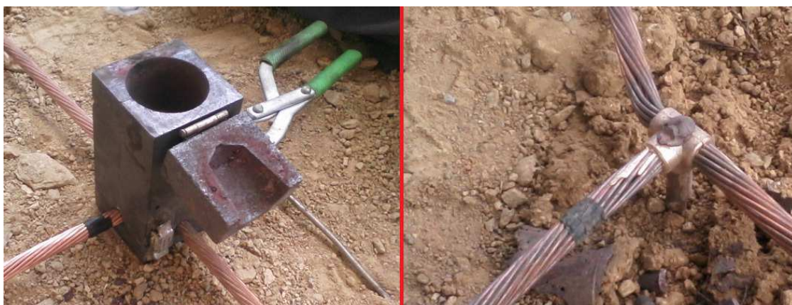
Figura 19. Fotos com detalhes da solda exotérmica cabo-haste em T. Fonte: Imagem própria, Brasil, 2012.
