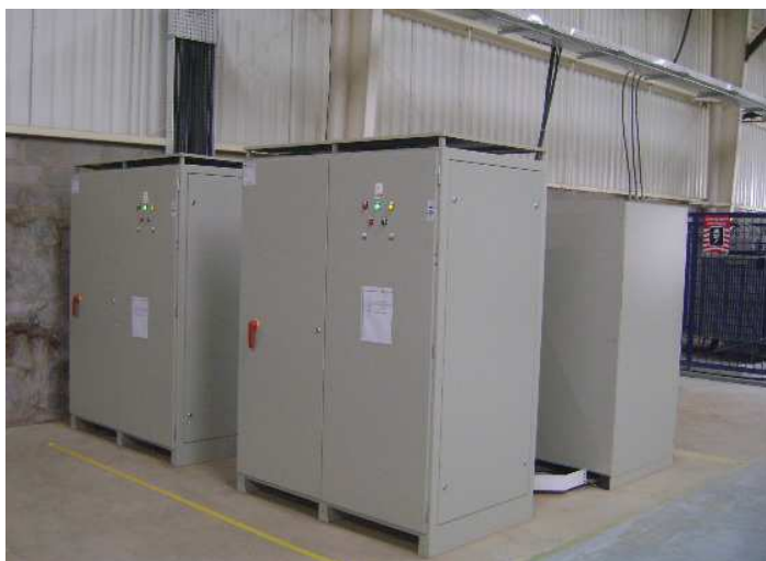
Figura 17. Foto dos retificadores Digatron e infraestrutura. Fonte: Imagem própria, Brasil, 2012.
