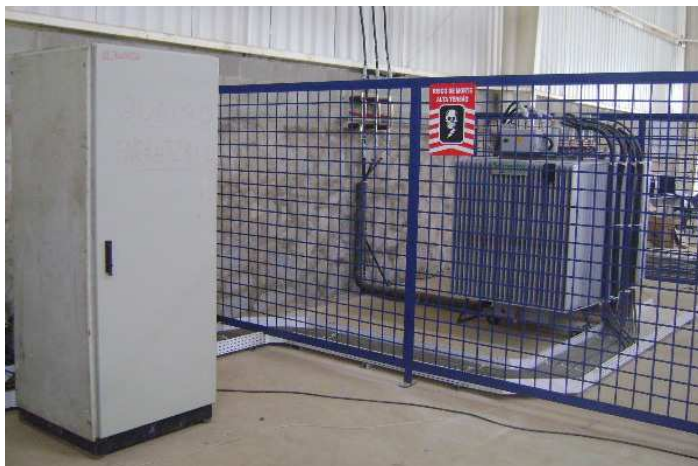
Figura 16. Vista lateral da SE provisória com o QGBT. Fonte: Imagem própria, Brasil, 2012.
