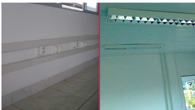
Figura 14. Vista da infraestrutura com tomadas e iluminação dos novos escritórios. Fonte: Imagem própria, Brasil, 2012.
