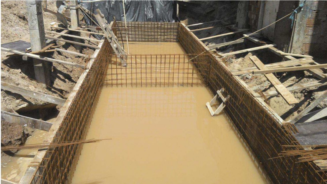
Figura 11 - Cisterna cheia de água devido às chuvas
