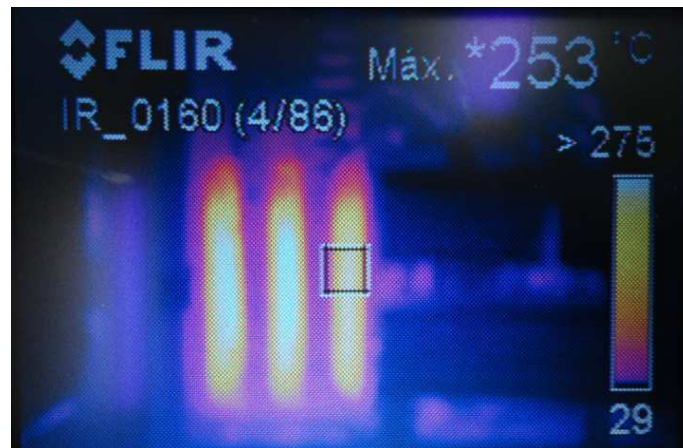
Figura 3.45 Termografia dos resistores do filtro RCD.
