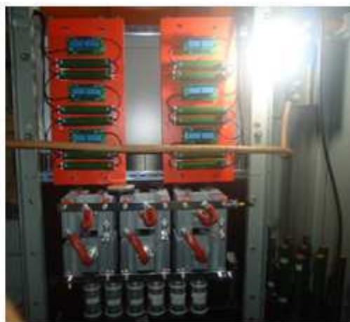
Figura 3.44 RCD instalado no painel do regulador de tensão.
