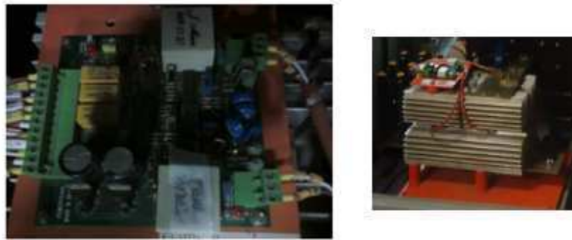
Figura 3.32 Placa de controle e sistema crowbar do gerador 01G4.
