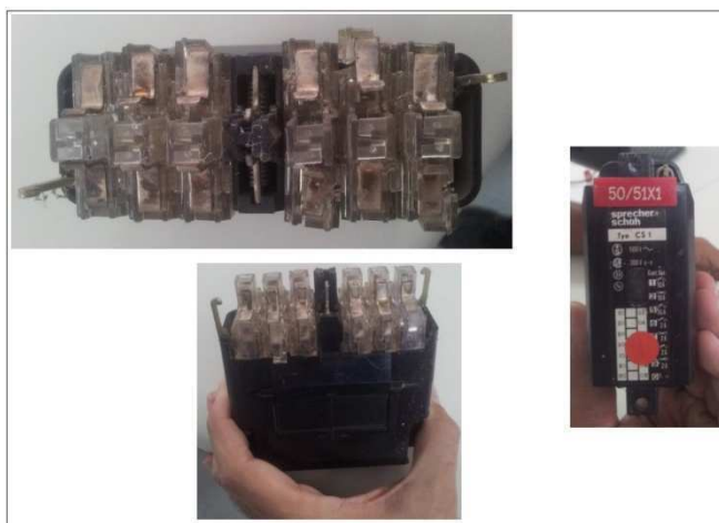
Figura 3.10 Relé auxiliar 50/51X1 do Vão I lado de 69 kV do 04T3.
