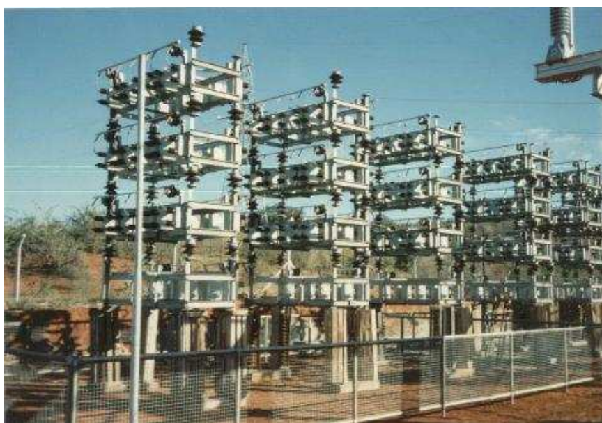
Figura 3.12 Exemplo de banco de capacitores.
